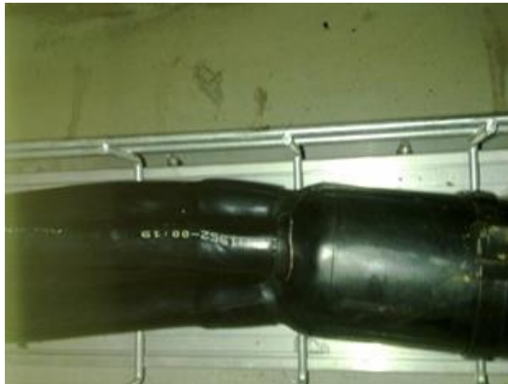
Abbildung 7-1: Risse im Schrumpfschlauch des Mittelspannungskabels.
