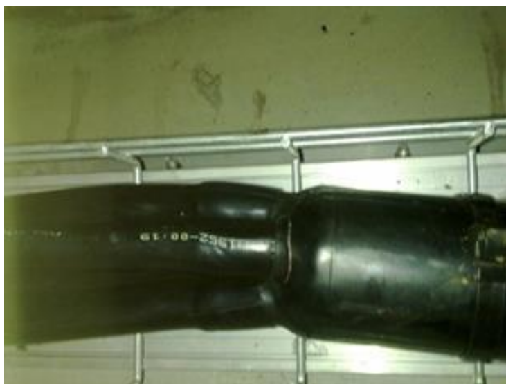
Abbildung 7-1: Risse im Schrumpfschlauch des Mittelspannungskabels.
