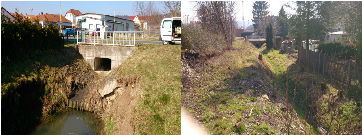
Abbildung 11: Bad Berka (li: schadhafter Gewässerabschnitt unterh. Straßenbrücke Fl.-km 0+990; re: Gewässerabschnitt Bad Berka Fl.-km 0+800 – Blick stromab
