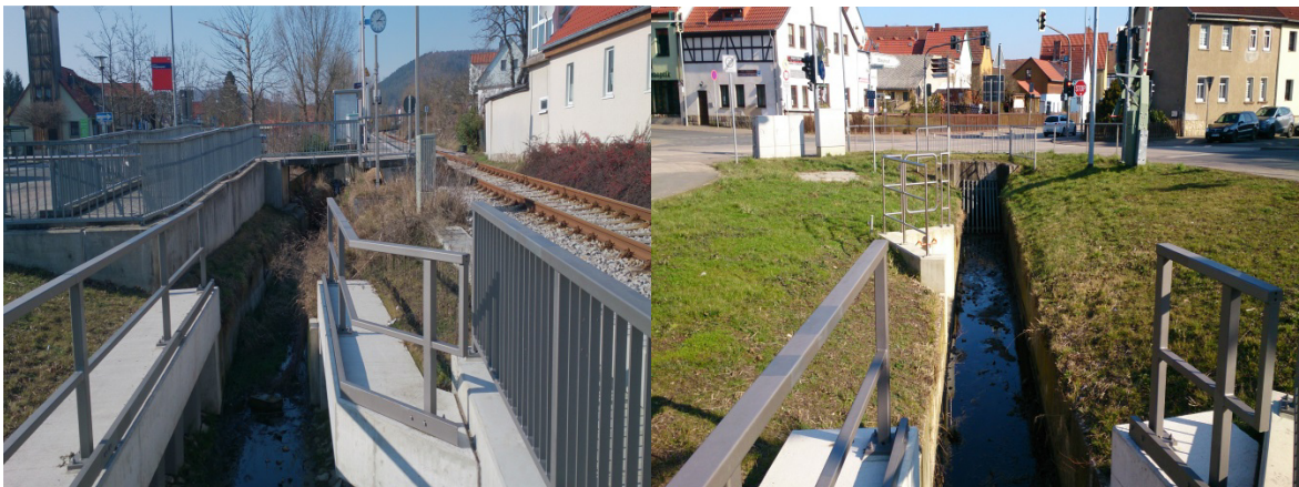
Abbildung 12: Bad Berka – Zeughausplatz (li: Hungerbach am Bahn-Haltepunkt – Blick stromauf ; re: Einlauf Verdolung Hungerbach
