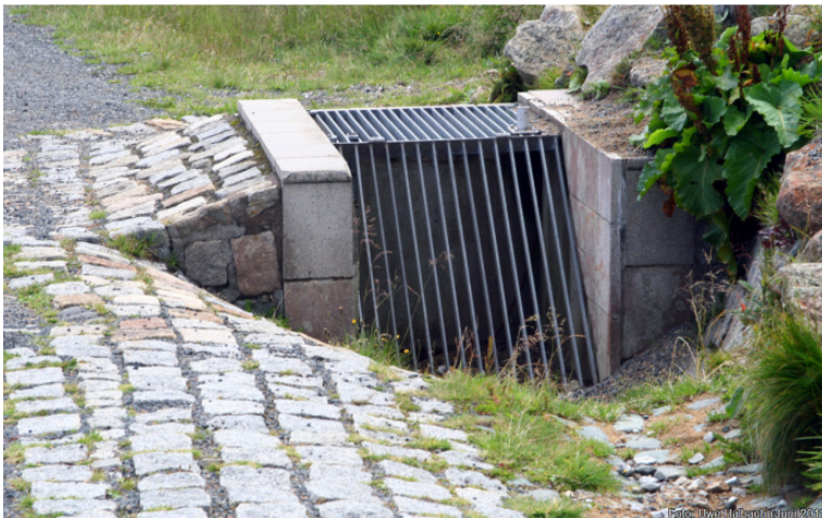
Abbildung 73: Beispiel Einlaufbauwerk mit Handrechen für kleine Gräben
