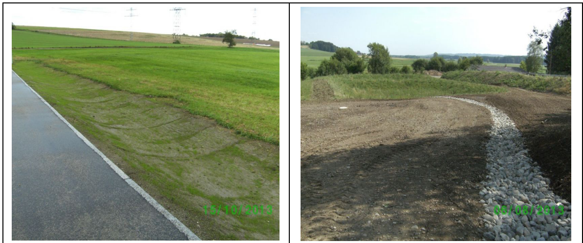
Abbildung 57: li: Mulden – Rigolen System (Quelle: IB Koschmieder); re: Retentions- und Sickerbecken (Quelle: IB Koschmieder)
