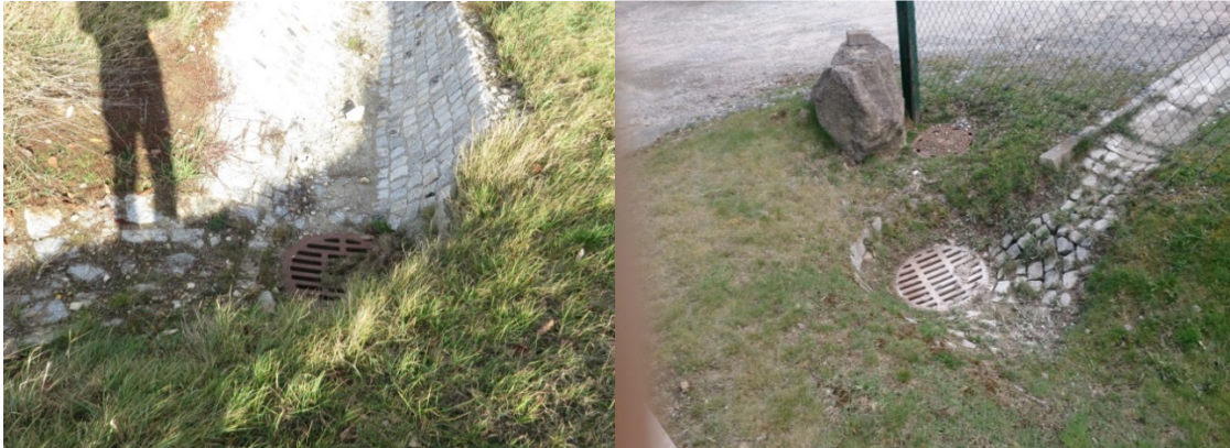
Abbildung 4: Fassung der Gräben an der L2155 am oberen Ortsrand
