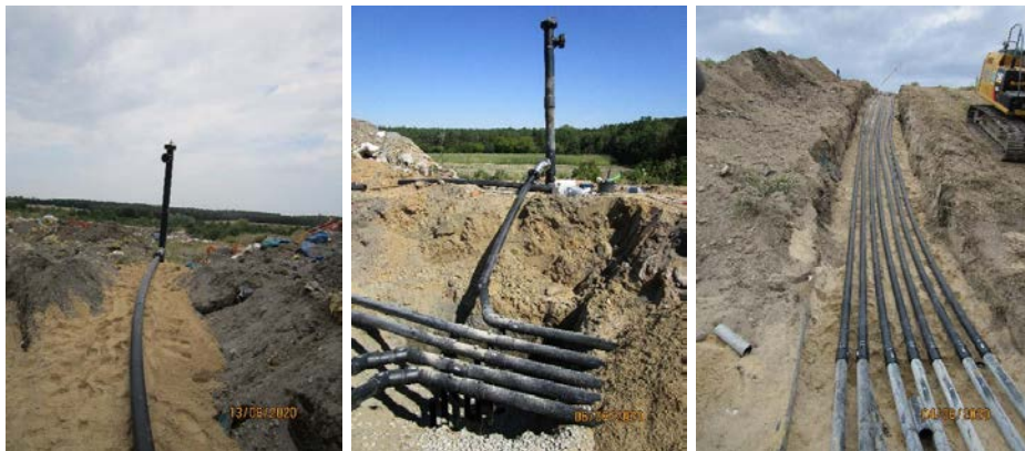
Abbildung 12: Deponie Lindenberg, Fotoaufnahmen zur Ertüchtigung der Gasfassungselemente im Ostteil im Jahr 2020 (aus [14])
