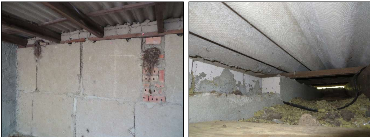
Abb. 9: Potentielle Fledermausquartiere an Gebäuden: Links Hohlräume in Hohlblocksteinen sowie Fugenspalten; Rechts Zwischenraum im frei zugänglichen Kalddach (F. Sieg, 14.06.2018)
