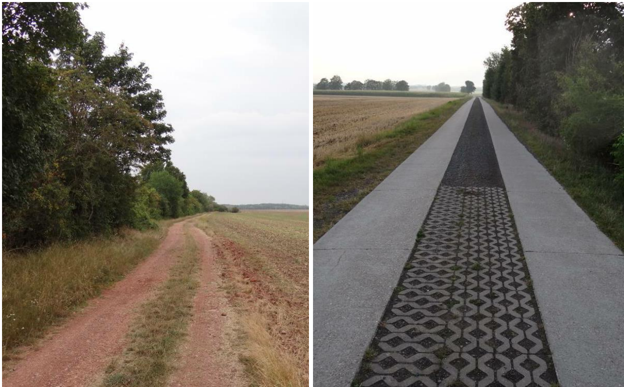
Abbildung 13: links: Überwiegend unbefestigter Weg nördlich der Bahntrasse (nur teils leichte Schotterung vorhanden); rechts: Befestigter Weg (Betonplatten mit geschottertem Mittelstreifen) befestigter Bankettbereich
