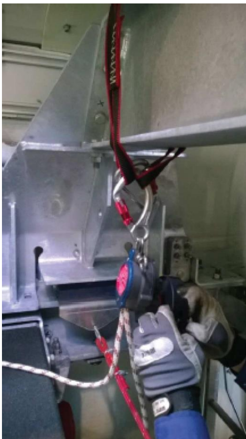
Abbildung 5.23: Am internen Ausleger befestigte Abstiegsvorrichtung
