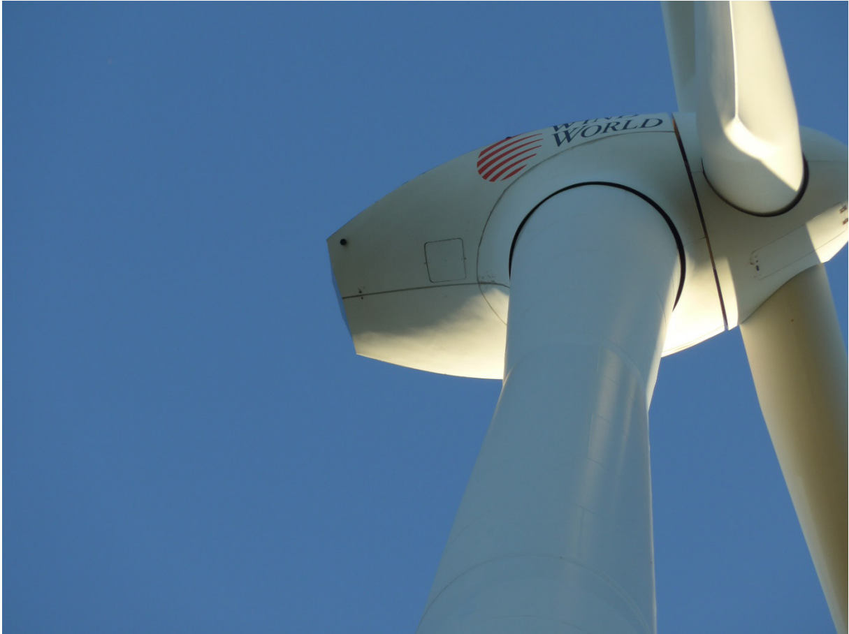
Abbildung 6: Installiertes Gondelmonitoring in einer der Windworld-Anlagen. Der schwarze Punkt am linken Ende der Gondel ist das Mikrofon.
