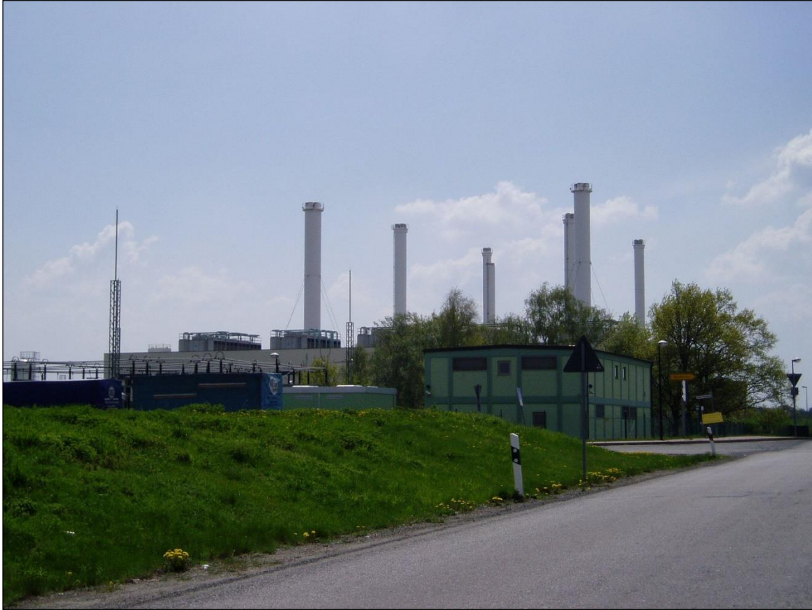
Abbildung 14: Blick auf die Energieversorgungscenter (EVC 1, EVC 2) aus Nordost
