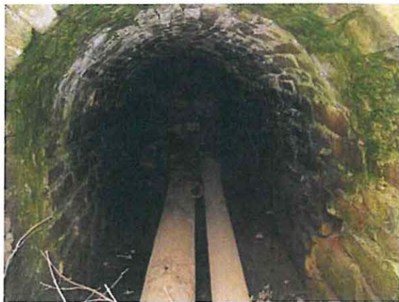
Abb. B 42: Einer der Leitungstunnel im Gebiet, hier südwestlich der Sehmabrücke der Tannenberger Straße, die Tunnel weisen ebenso wie die Straßenbrücke potenzielle Spaltenverstecke auf 4
