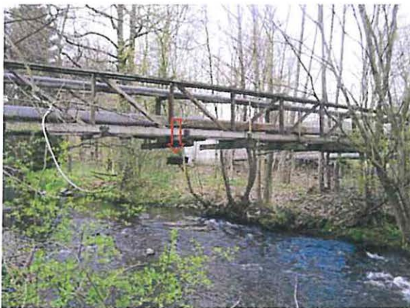
Abb. B 41: Eine der alten Heizleitungstrassen im Gebiet, hier über die Zschopau westlich der Brücke der B 95; der Pfeil markiert eine Nisthilfe 4
