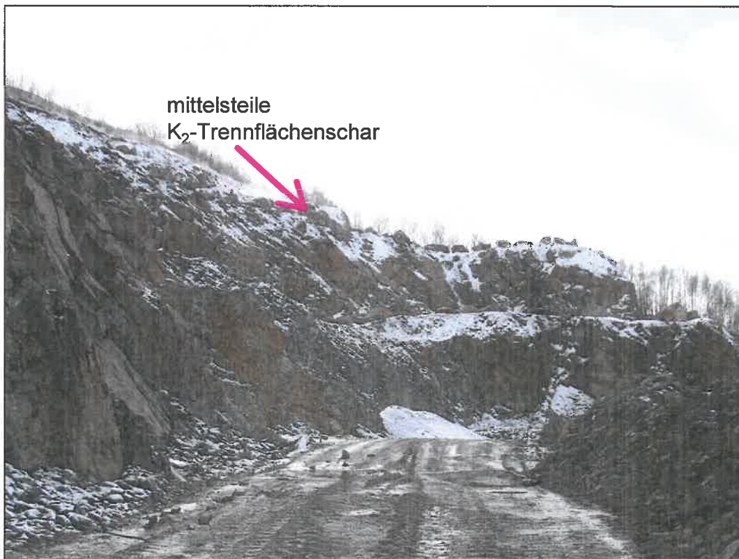
Bild 12: Blick in mittelsteile K_2 -Trennflächen vom Flammengneis
