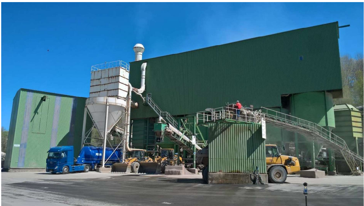
eingehauste stationäre Aufbereitungsanlage mit Filtersilo der Entstaubungsanlage und Silofahrzeug; Wand an der Verladeanlage; Bandabdeckung am 2. Verladeband mit Verladebalg; feucht gereinigte Hoffläche
