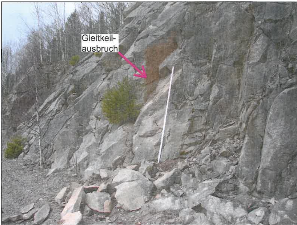
Bild 23: klassischer Gleitkeil-ausbruch an der Zufahrt zur oberen Sohle im Nordböschungssystem
