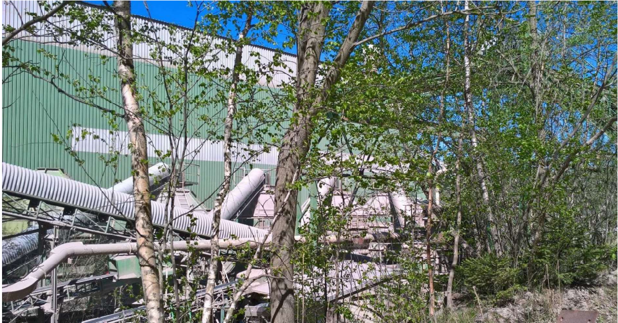
Bandabdeckungen und Trichter an Siebmaschinen und Brechern; eingehauste Anlage im Hintergrund
