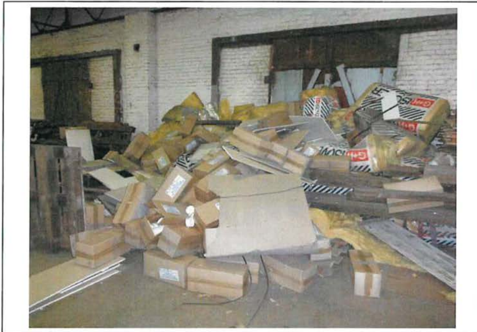
Blick auf Ablagerungen (Rigips-Bewehrungsbinden, Dämmmaterial etc.) im Schuppen C
