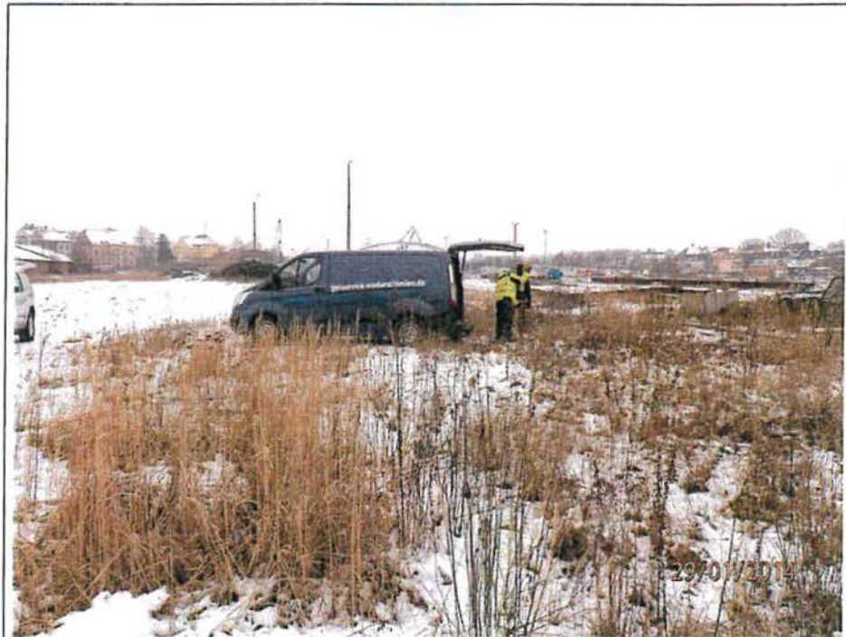
Foto 7: Das Foto vom 29.01.2014 zeigt die Arbeiten zum Abteufen der RKS 8c/ BG 05 - 2014 durch das Fachbohrunternehmen GEOSERVICE NIEDERSCHLESISIEN, Brunnenbauermeister Frank Stein aus 02943 Weißwasser.
