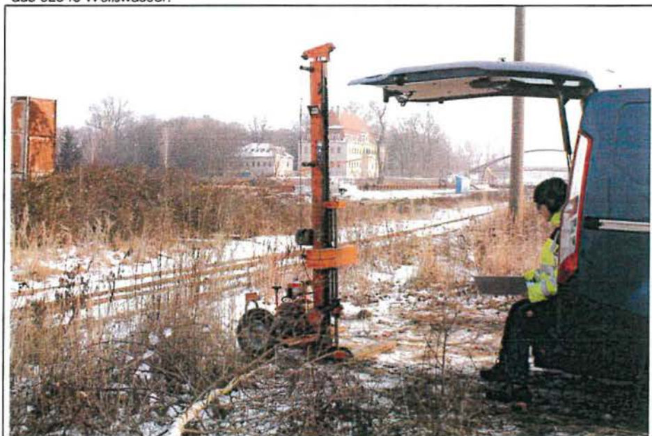
Foto 8: Das Foto vom 30.01.2014 dokumentiert die Aus-/ Durchführung der Schweren Rammsondierung mit der Kurzbezeichnung DPH 4/ BG 05 - 2014.
