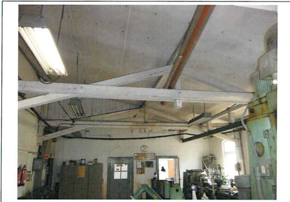
Blick die Asbestdeckenverkleidung im Werkstattbereich
