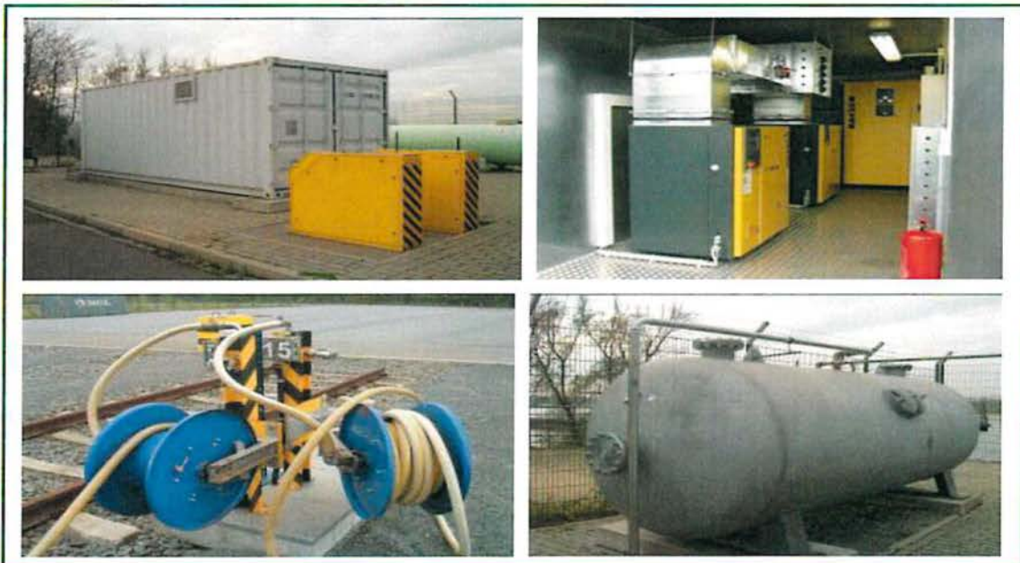
Bild 21: Beispiel einer Bremsprobeanlage
