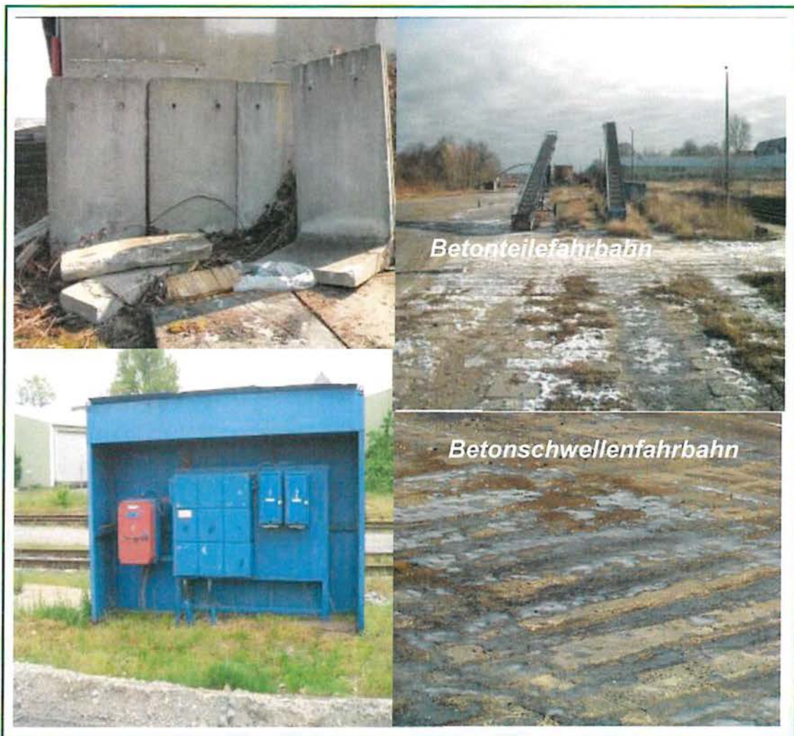
Bild 13: Ausgewählte Ansichten von Oberflächenbefestigungen, Mauereinfriedungen und einer Stromverteilerstation im Hafen Riesa
