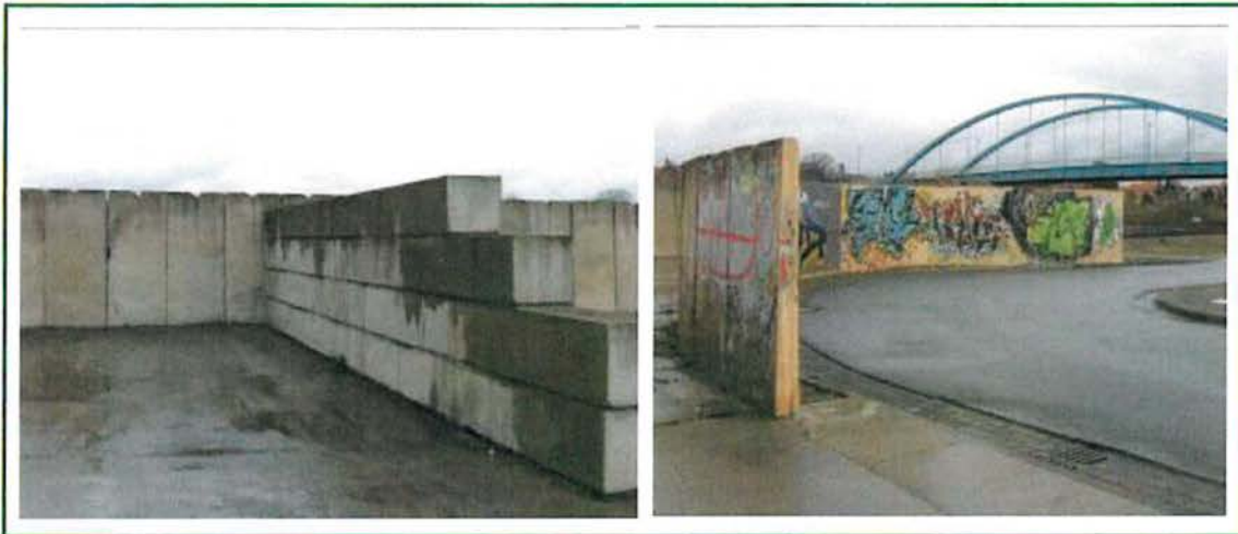
Bild 11: Betondecke und Mauereinfriedungen im Bereich der vormals durch die Abbruch & Recycling GmbH Dresden betriebenen Mischanlage
