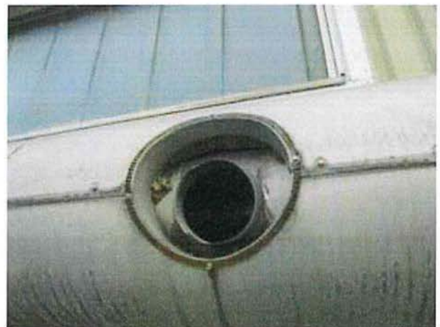
Probe F 4 Dämmung Rohrleitungsbestand, Dämmwolle (alte Mineralwolle, KMF mit WHO- Faseranteil)
