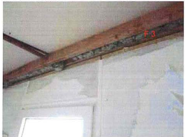
Probenahmebereich F 3: Miwo-Dämmung mit WHO-Faseranteil im Bereich der Deckenkonstruktion
