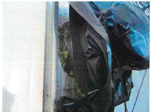
Probe F 1, Dämmwolle (alte Mineralwolle, KMF mit WHO-Faseranteil)
