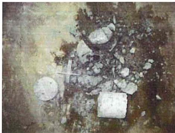
Betonbohrkern KB 10 WP (zerfallen)
