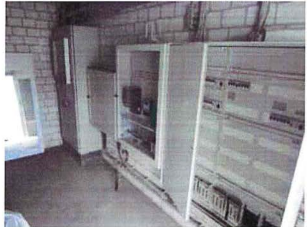
Schaltzentrale mit Sicherungs-/ Zähler- und Steuerschrank
