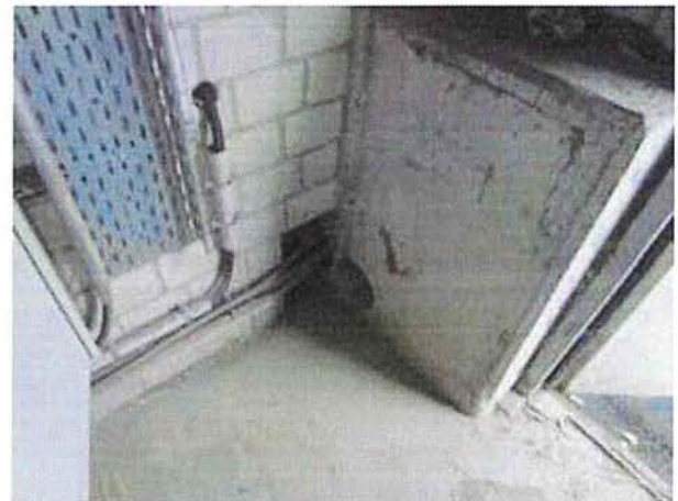
Teilabschnitt Warmhalle Achse 8-9: Schaltzentrale mit Einführung EIt-Kabel im Abbruchbereich
