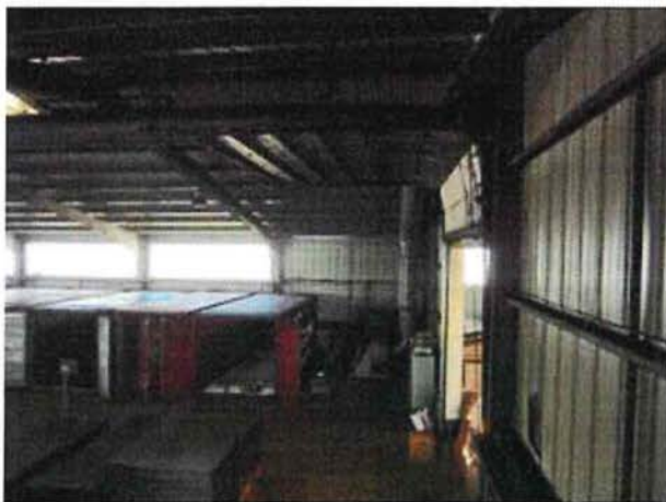
Probenahmebereich Probe F 1 (Warmhalle, Westseite) Dämmung Hallenwand
