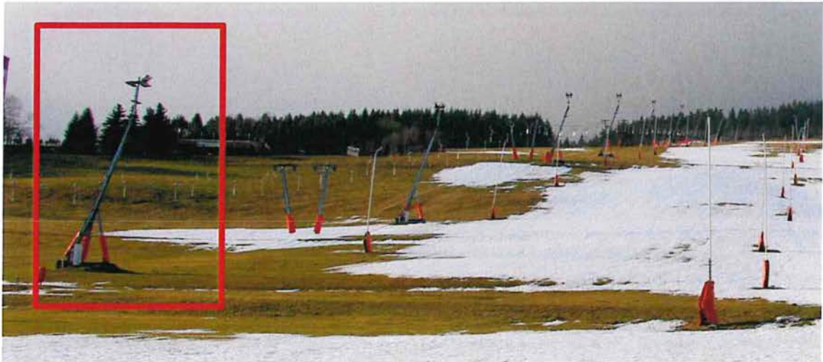
Abbildung 17: Bestands-Beleuchtungsanlage Kl. Fichtelberg (Schweiger)
