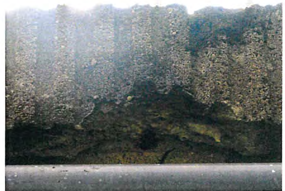
2016H BETON AUSBRÜCHE AM GESIMS UNTERSTROM
