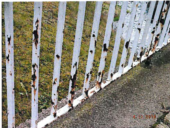
2016H GELÄNDER ROSTSCHÄDEN
