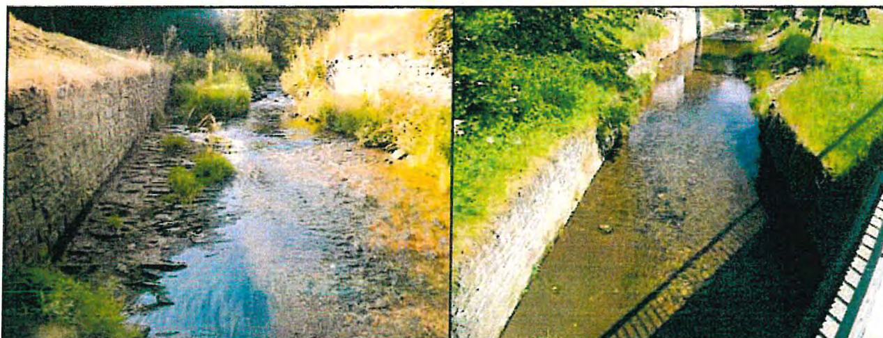
Abbildung 2: Ansicht oberstrom (linkes Foto, 31.07.2018) und unterstrom (rechts, 27.06.2016) mit Ufer- und Sohlbefestigungen im Bereich des Brückenbauwerkes und des Pegels.
