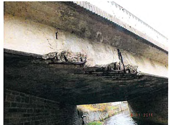
2016H ABGEPLATZTER BETON RECHTE SEITE
