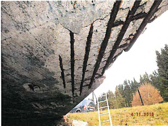
2016H BETONABPLATZUNGEN OBERSTROM SCHADENSERWEITERUNG
