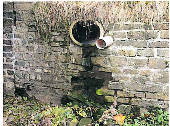
2016H TEILEINSTURZ UFERMAUER UNTERSTROM LINKS
