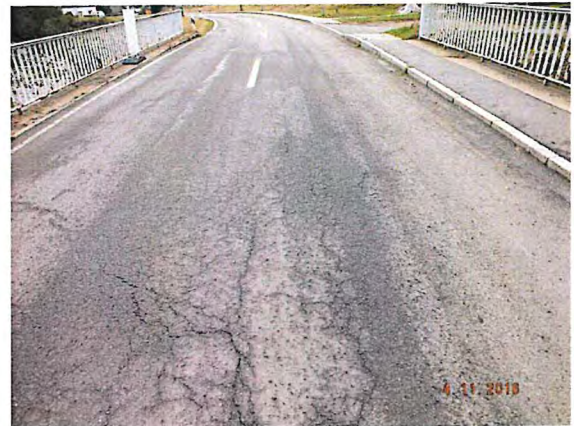
2016H FAHRBAHNBELAG RISSIG
