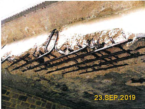
EP 2019 - BILD 01 - MÜRBER ÜBERBAUBETON
