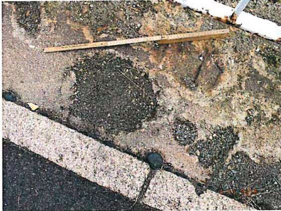
2016H KAPPE BETONSCHÄDEN UND FE
