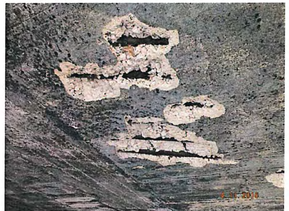
2016H ABPLATZUNGEN UNTERSEITE FREILIEGENDE EISEN MINDERFESTER BETON
