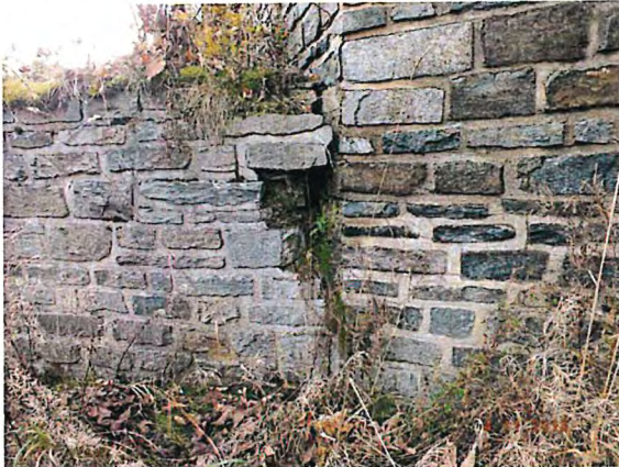
2016H AUSBRUCHSTELLE UFERMAUER OBERSTROM
