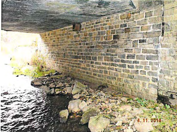
2016H ABLAGERUNGEN VOR WIDERLAGER HINTEN
