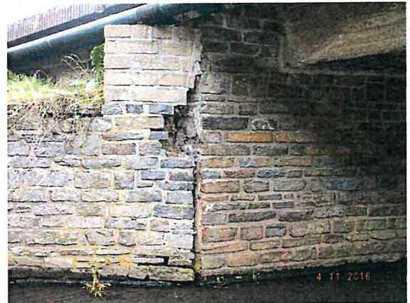
2016H UFERMAUER VORN RECHTS FEHLENDE STEINE
