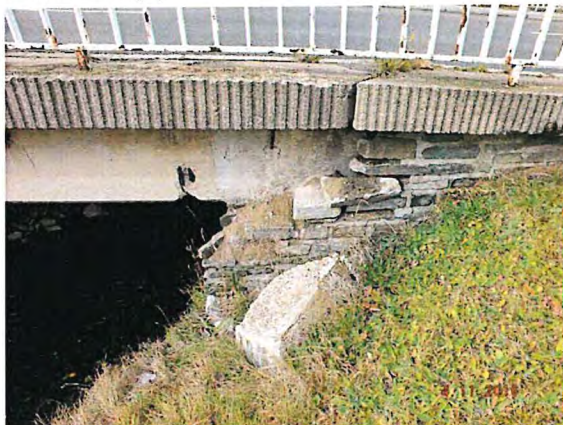
2016H KAMMERWAND VORN LINKS EINGESTÜRZT
