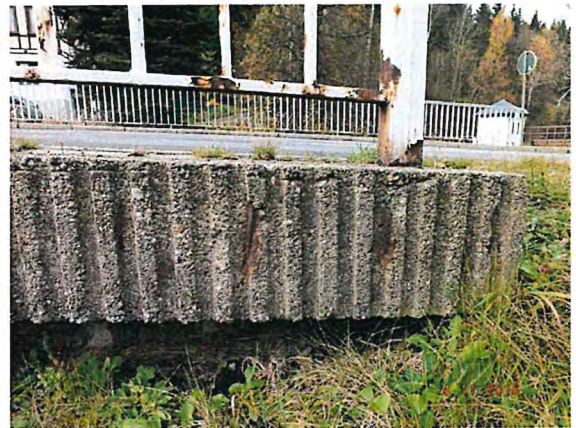
2016H FREILIEGENDE KAPPENBEWEHRUNG
