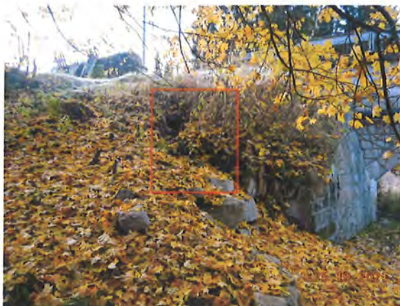
2021E-15-BÖSCHUNG VORN RECHTS IN FORTSETZUNG DER PFLASTERMULDE AUSGESPÜLT
