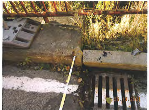
2021E-08-KAPPENENDE HINTEN LINKS-FREILIEGENDES ENDE EINES BEWEHRUNGSSTABS
