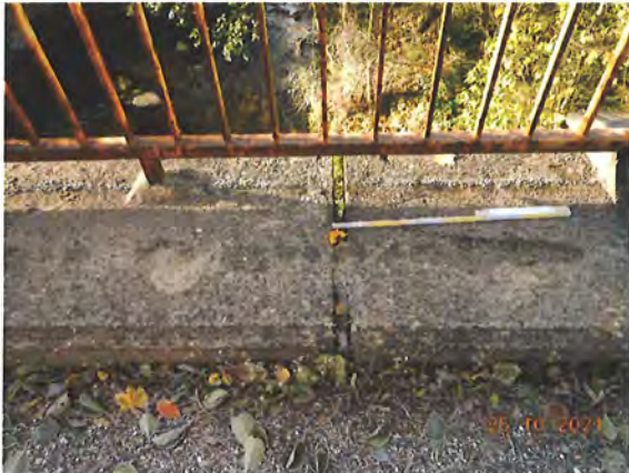
2021E-06-KLAFFENDE FUGEN DER SIMSFERTIGTEILE
