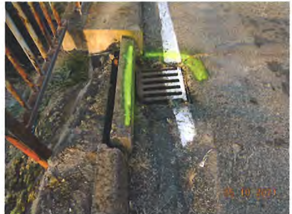
2021E-07-LOSER BORD AN DER ABGÄNGIGEN BANKETTBEFESTIGUNG VORN LINKS
