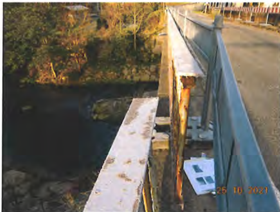
2021E-09-NACH AUSSEN GEKIPPTES GELÄNDER IN BÖSCHUNG VORN LINKS
