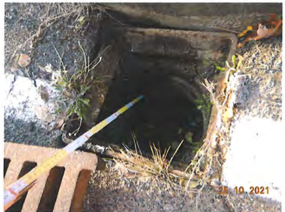
2021E-11-ABLAUF VORN LINKS-GEBOCHENES FERTIGTEIL-ABGESACKTER ROST
