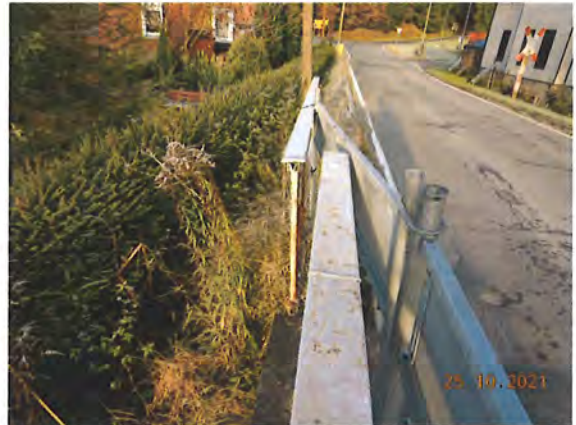
2021E-10-GELÄNDERSCHADEN HINTEN LINKS-SICHERUNG NICHT AUSREICHEND
