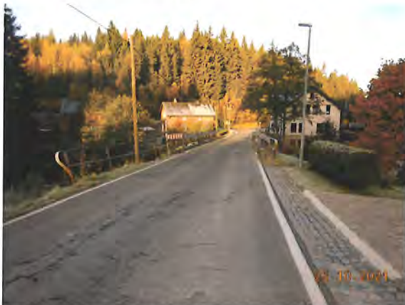
2021E-02-KEIN GESICHERTER GEHWEG AUF DEM BW
