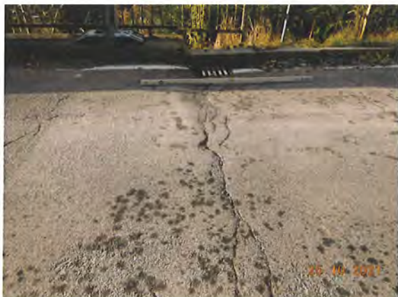
2021E-13-ÜBERBAUENDE HINTEN LINKS-BELAG GERISSEN UND 3CM ABGESACKT
