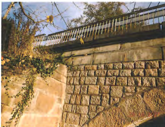
2021E-05-BETONFERTIGTEILE STIRNWAND HINTEN LINKS-FEHLLENDE FUGENFÜLLUNG
