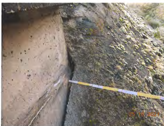
2021E-14-ABGÄNGIGER BETON AUF DER BÖSCHUNGSSCHULTER VORN LINKS
