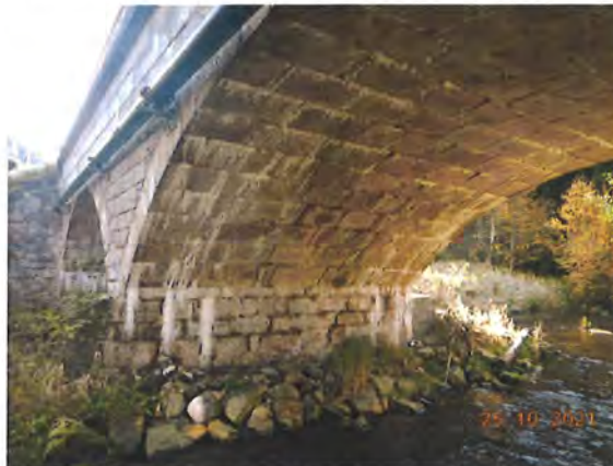
2021E-04-BOGEN 2 DURCHFEUCHTET MIT AUSSINTERUNGEN
