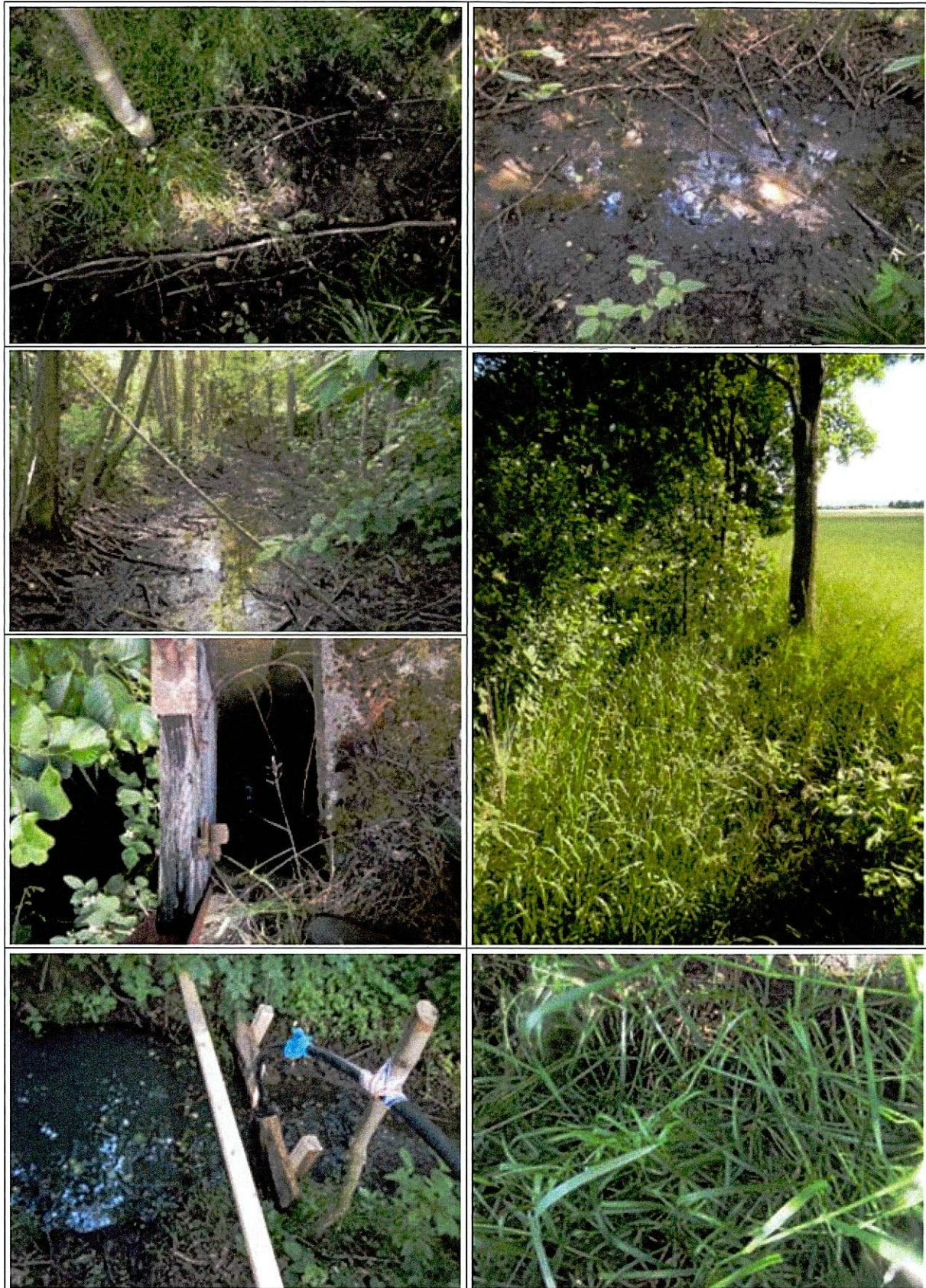
Abbildung 28: Pressegraben Abschnitt 1 – Trockengefallener Gewässerabschnitt (o.l.), feuchtschlammiges Gewässerbett (o.r.), wasserarmer, mit Wurzeln durchsetzter Abschnitt (2.Reihe links), Gewässer und Ufer sind dicht mit Vegetation bewachsen (2.Reihe rechts), Absperrvorrichtung an einem Durchlass (3.Reihe links), provisorische Holzversperrung mit Zulauf (u.l.), dicht mit Gräsern bewachsener Abschnitt (u.r.)
