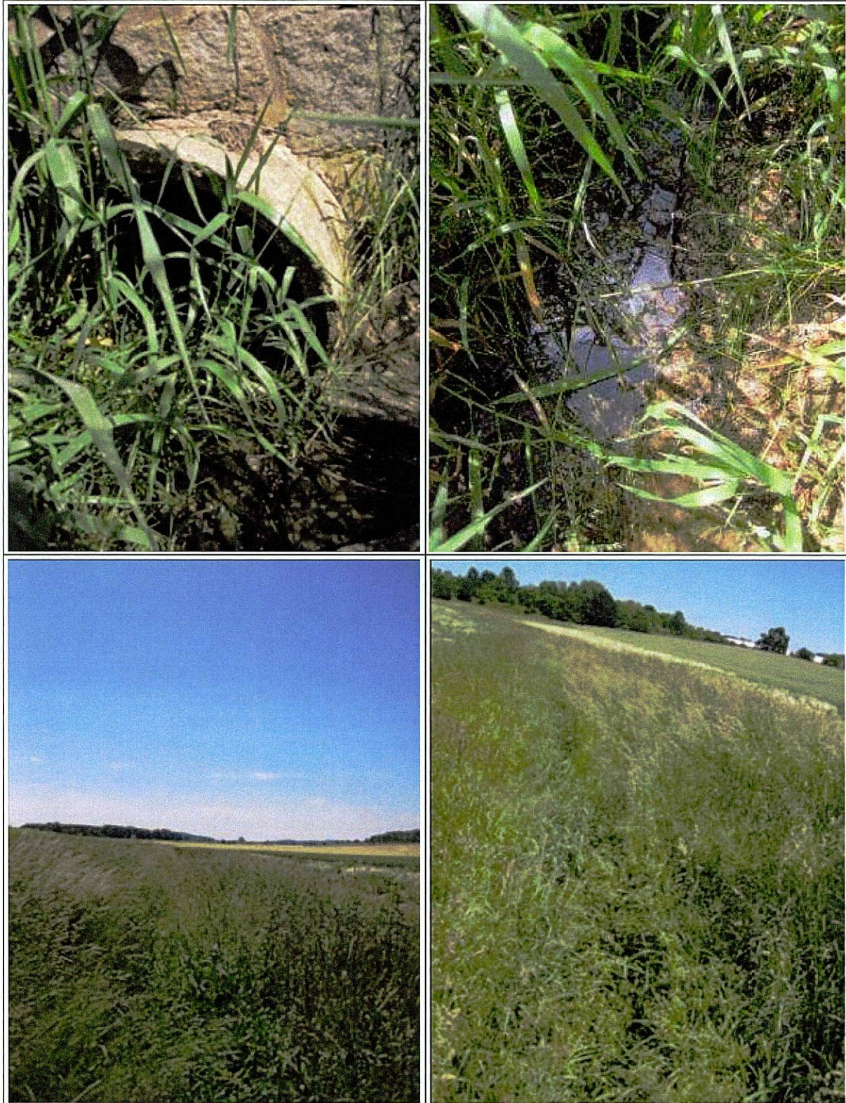
Abbildung 24: Maltitzbach Abschnitt 2 – Rohrdurchlass (o.l.), Gewässerabschnitt mit Schlammauflage und Grasbewuchs (o.r.), hoch gewachsene Grasfluren nehmen die Böschungen ein (u.l.), der Graben ist weitgehend von Vegetation überwachsen (u.r.)
