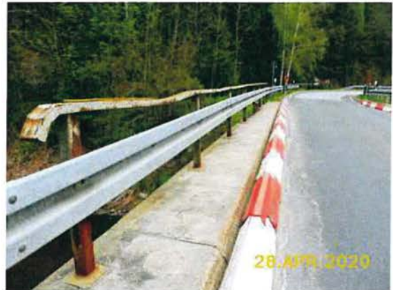
20E-027-HINTEN RECHTS - GELÄNDER NACH AUßEN GEKIPPT - HANDLAUF VERBOGEN - ROST
