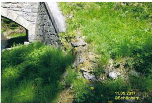
17H-016-VORN LINKS - ZERFALLENE UFERMAUER
