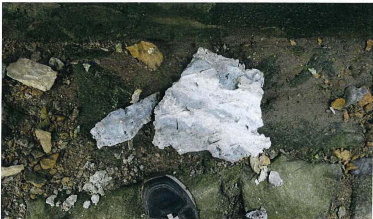
Abb. 4: Nach der Begutachtung 2016 kam es zum Aufplatzen vieler Fugen.
