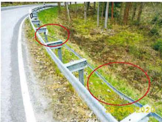
20E-020-HINTEN RECHTS - SPANNBAND 2X VERBOGEN
