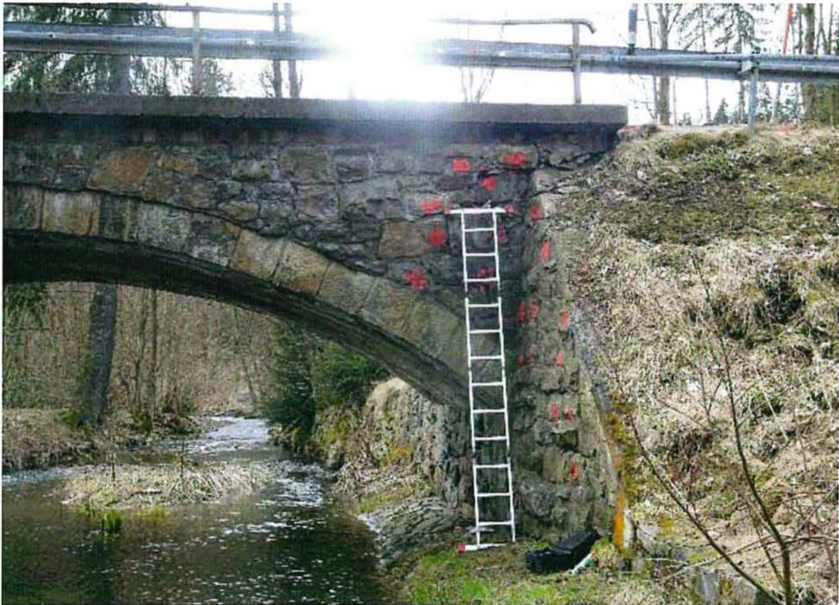
Abb. 5: Somit wurde 2021 eine erneute Begutachtung erforderlich.
