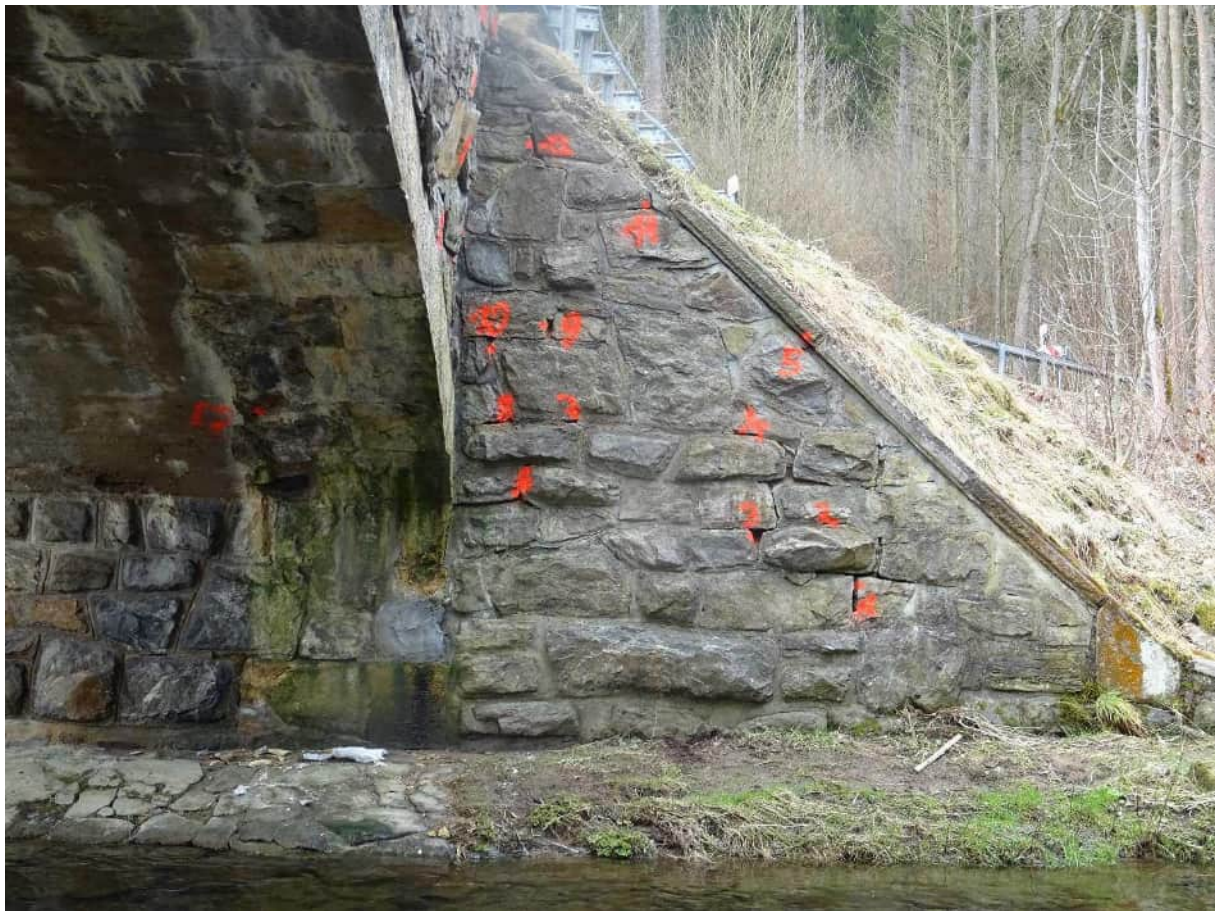
Abb. 9: Westufer mit Flügel Nordwest (F NW) und Stirnwand NW, Strukturen 1-12
