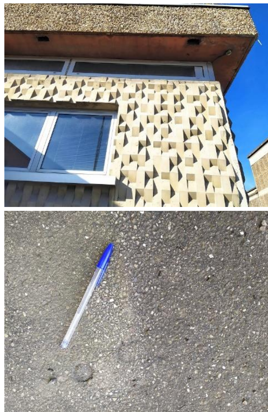
Photo 11 : Ouvertures sous le toit du bâtiment vestiaire-douche et guano présent sous ces ouvertures
