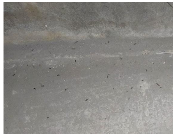
Photo 9 : Guano au sol présent dans le bâtiment de stockage du tri sélectif 2 (est) (Photo : Rainette, 2021)
