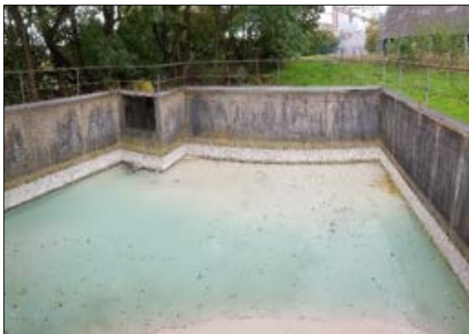
Photo 12 : Bassin de récupération d'eau (Rainette, 2020)
