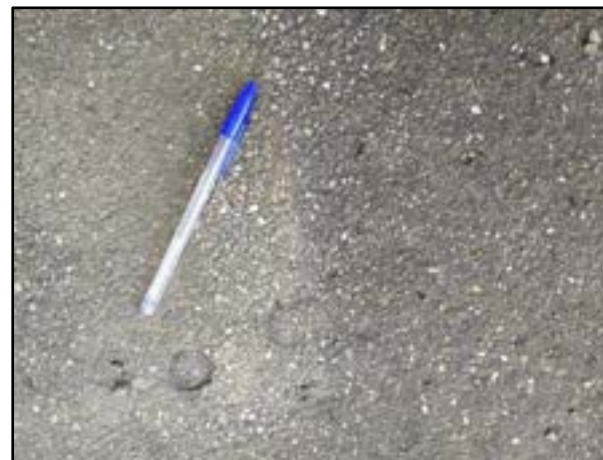
Photo 12 : Guano présent sous les ouvertures. Le stylo donne une échelle pour la taille des fèces.
