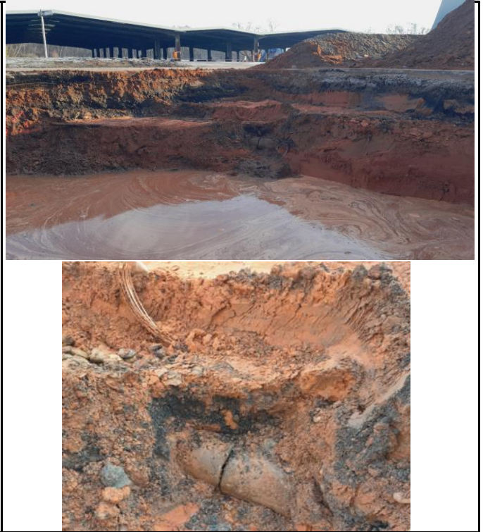
Mise en évidence d'un conduit béton fuyard
