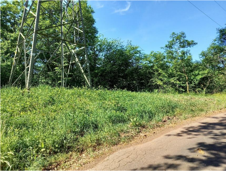
Abbildung 15: Mastfuß Mast 9 mit Aufwuchs von Ruderalvegetation.
