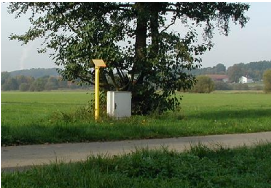
Abbildung 8: KKS-Anlage (Kleinverteilerschrank und Schilderpfahl)
