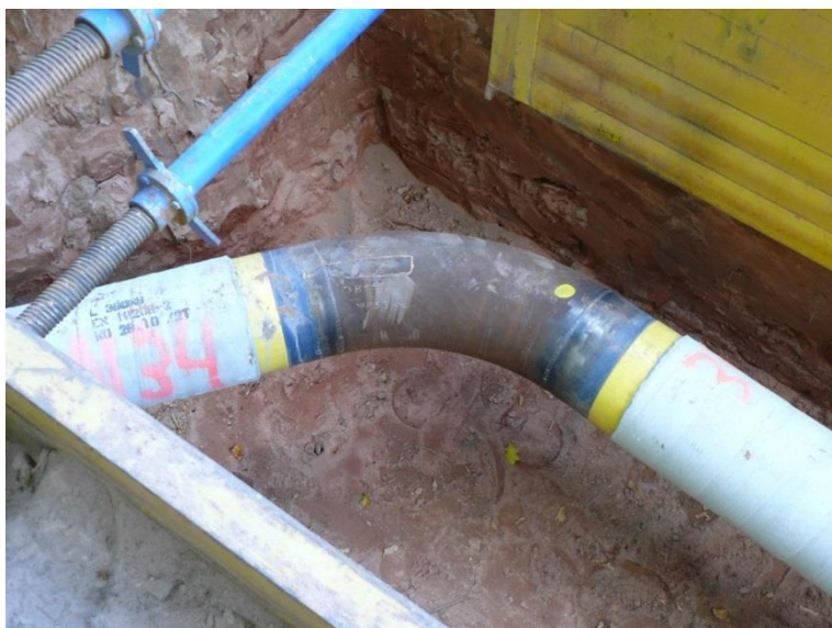
Abbildung 18: eingeschweißter Rohrbogen im Bereich eines Kopfloches
