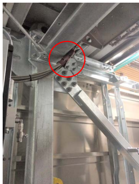
Bild 6: Scheuerschutz bauseits ("Speckmatte")
