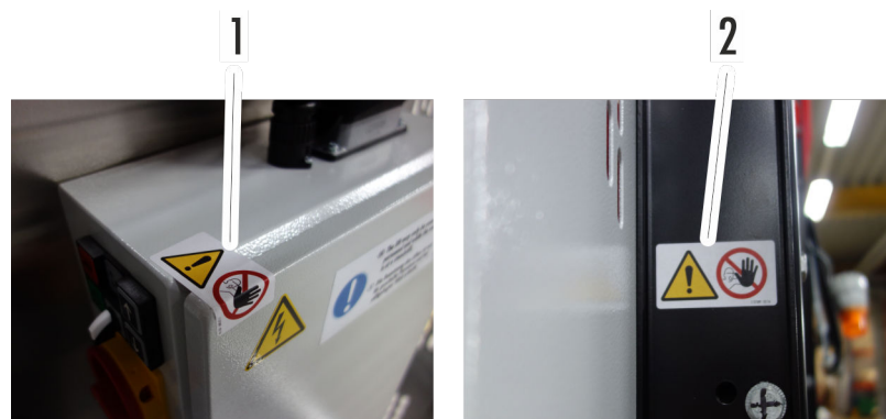
Abb. 8: Siegel Schaltschrank und Überlast
