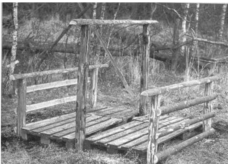
Die Seiten sind verlattet, die Pfähle in Längsrichtung verbunden. Die zweite Palettenschicht ist angebracht, das Rohr aufgestellt.
