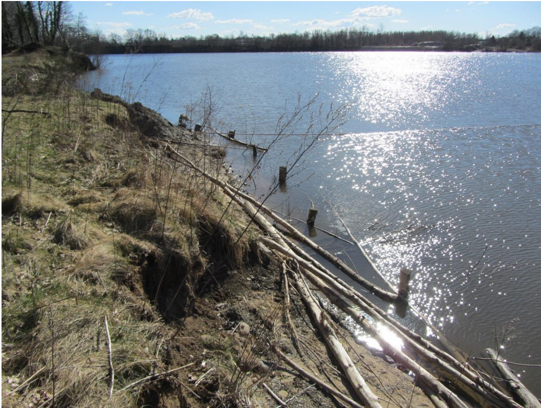
Abbildung 3: Hochwasserschäden an sanierter Nordostböschung, März 2018
