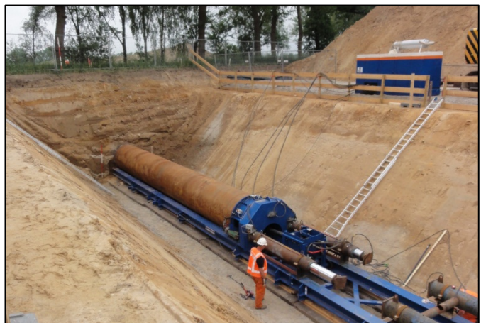
Abbildung 19: Pressgrube mit Pressgerät (Ltg. DN 1400)
