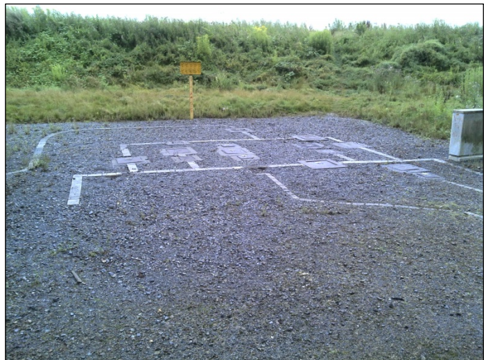
Abbildung 10: Beispiel einer Armaturenstation (hier ohne Ausbläser und umlaufende Kette)
