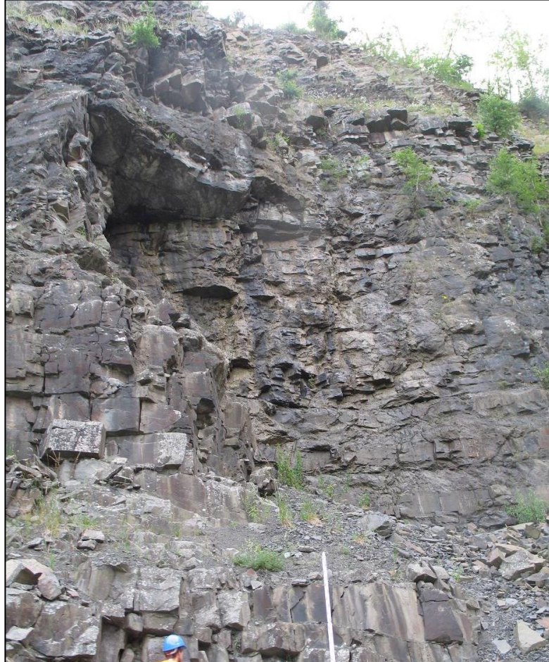
Abbildung 23: Ostwand, nachbruchgefährdeter Überhang im Abschnitt 2.
