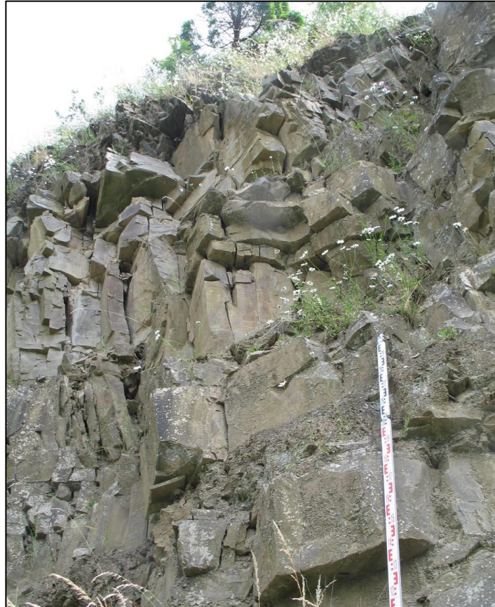
Abbildung 24: Ostwand, nachbruchgefährdete Kluffkörper (Steine und Blöcke) im Abschnitt 1.
