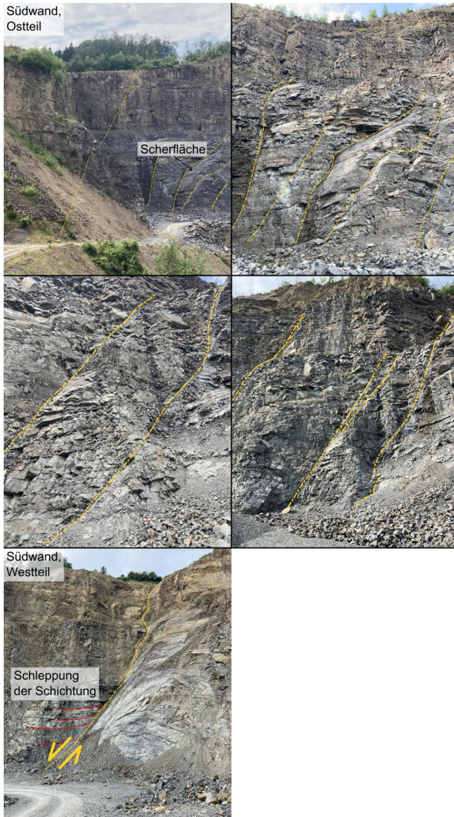
Abbildung 9: Störungen entlang der südlichen Abbauwand des Steinbruchs.
