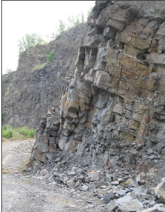
Abbildung 25: Ostwand, nachbruchgefährdete Kluftkörper (Steine und Blöcke) im Abschnitt 3.
