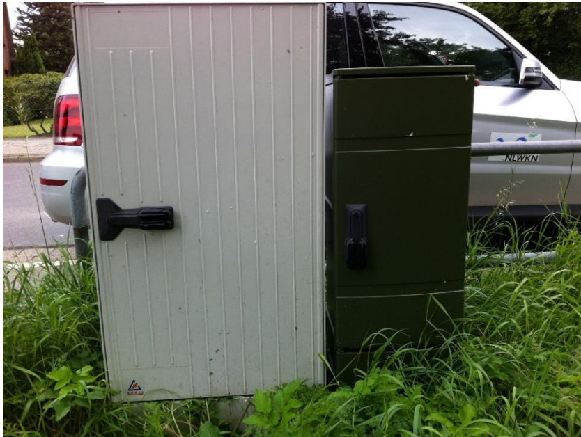
Abbildung 9: Beispiel für einen Außenschaltschrank links: Mess- und Übertragungstechnik, rechts: EVU Anschluss © jbi 2012 Ochtumverband
