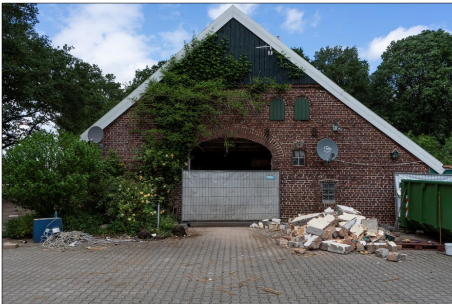
Abb. 19 Wohnhaus Standort Horenfeld 20 (Süd-Seite). Das Haus soll abgerissen und durch ein neues Haus ersetzt werden.
