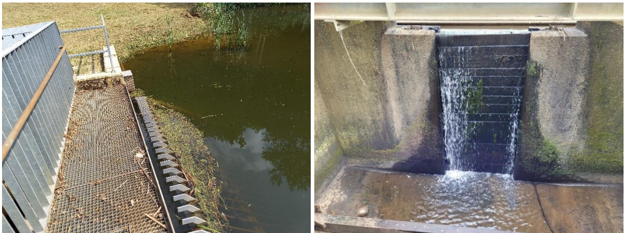
Abbildung 28: Rechen am HRB (links); zu entfernende Dammbalken (rechts; Foto: WV RSK, 2022).
