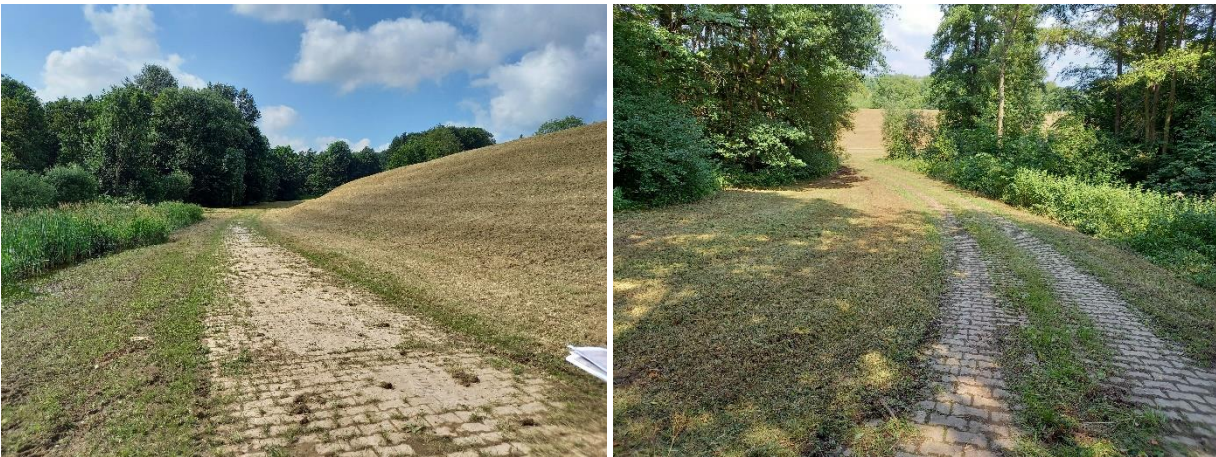
Abbildung 30: vorhandener Unterhaltungsweg am Dammfuß (links) sowie in südöstlich Richtung durch das Gehölz südlich des HRB (rechts).
