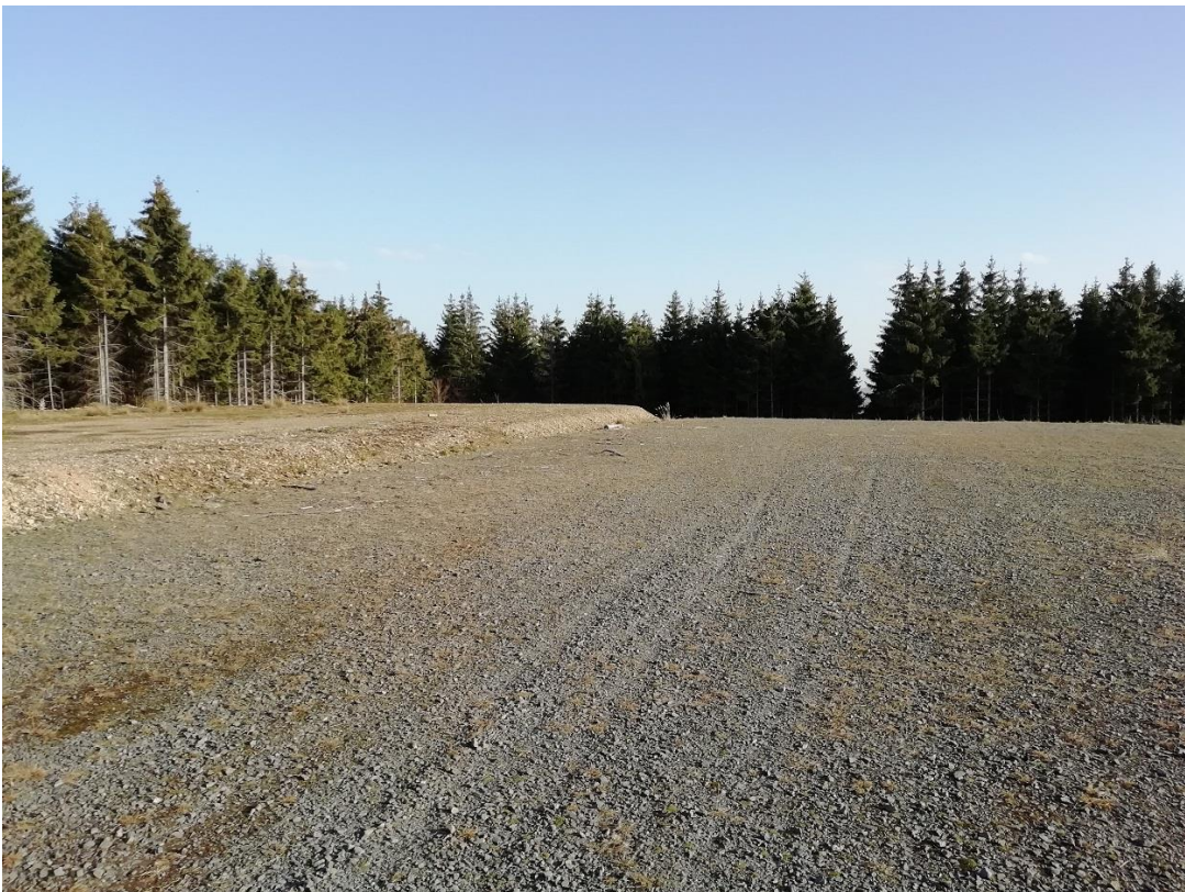
Abbildung 7b: Kranstellfläche (VF1; Nr. 7-2) und angrenzende Schotterfläche aus autochthonem Material (GF1; Nr. 7-6) der WEA 7 (Blick in südöstliche Richtung)
