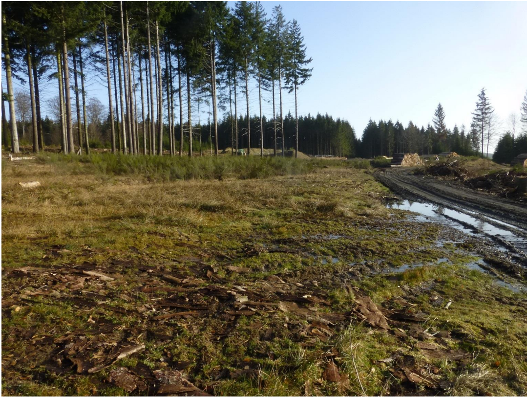
Abbildung 8e: Kranmontagefläche (AT1, neo1; Nr. 8-8) mit stauassem Bereich der WEA 8 (Blick in nordöstliche Richtung)
