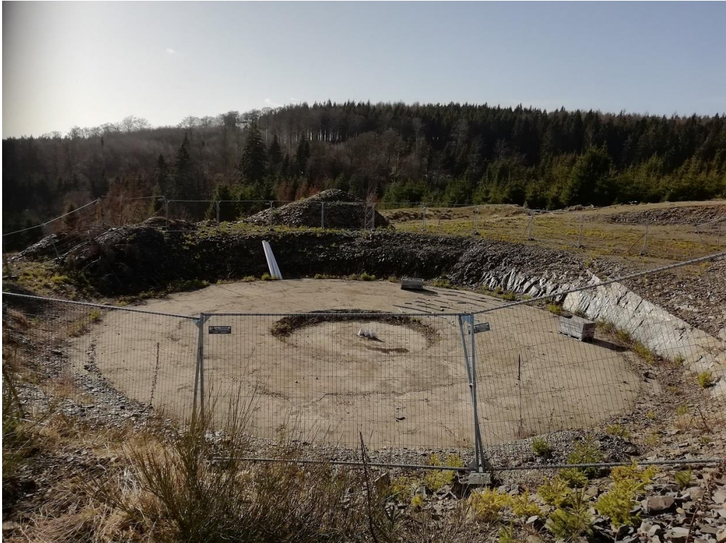
Abbildung 4f: Fundamentgrube (VF0; Nr. 4-1) und angrenzende Böschungen (HH0; Nr. 4-4) der WEA 4 (Blick in südwestliche Richtung)
