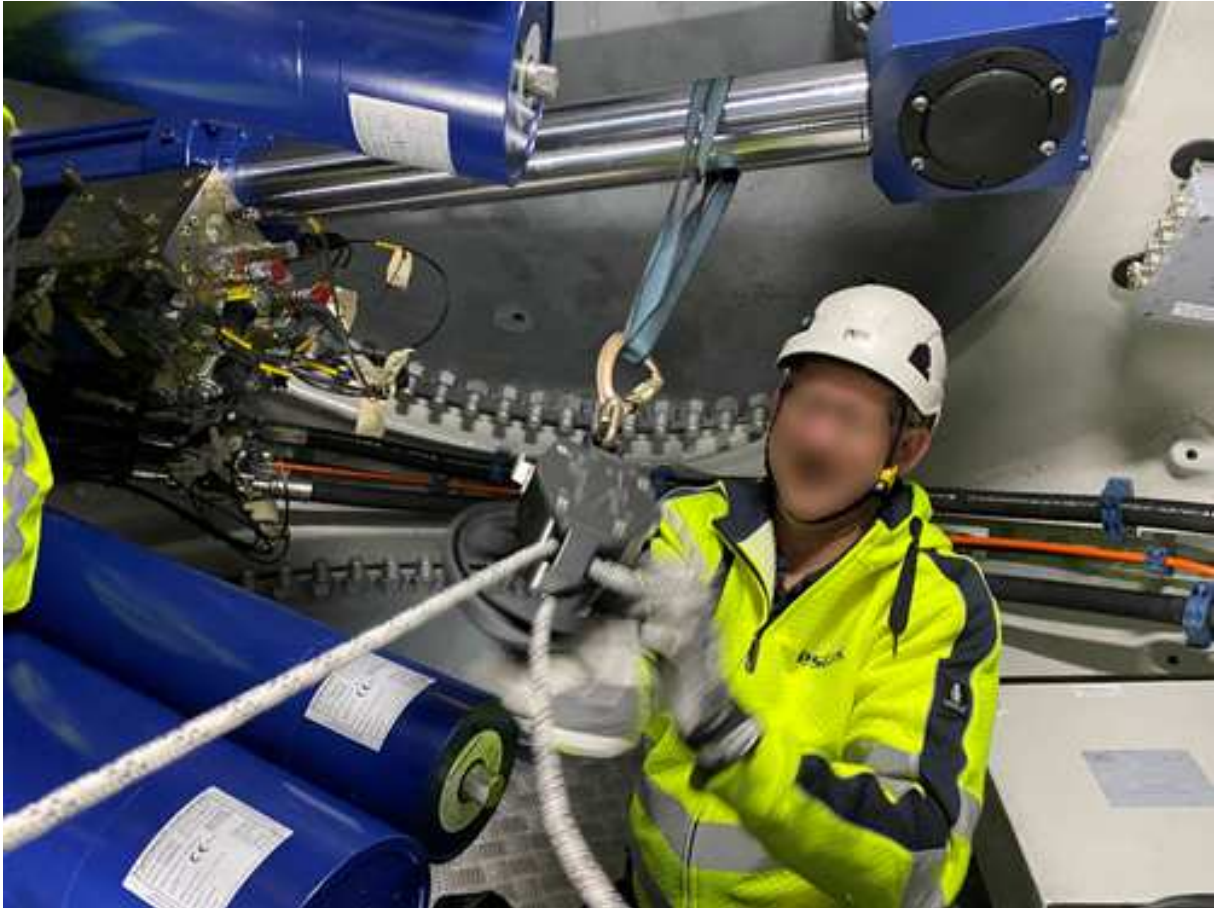
Abbildung 7.27: Befestigung der Notabstiegsvorrichtung am Pitchzylinder
