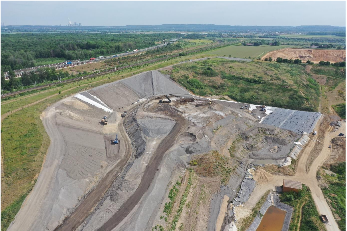
Abbildung 5: Blick nach Nordost auf den Deponiekörper und den rekultivierten Altkörper (links im Bild)
