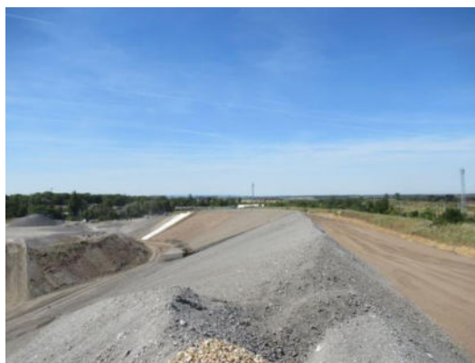
Abb. 15 Derzeitiger Verfüllbereich S' der Anlehnungsböschung der Zwischenabdichtung auf den Altteil der Deponie.
