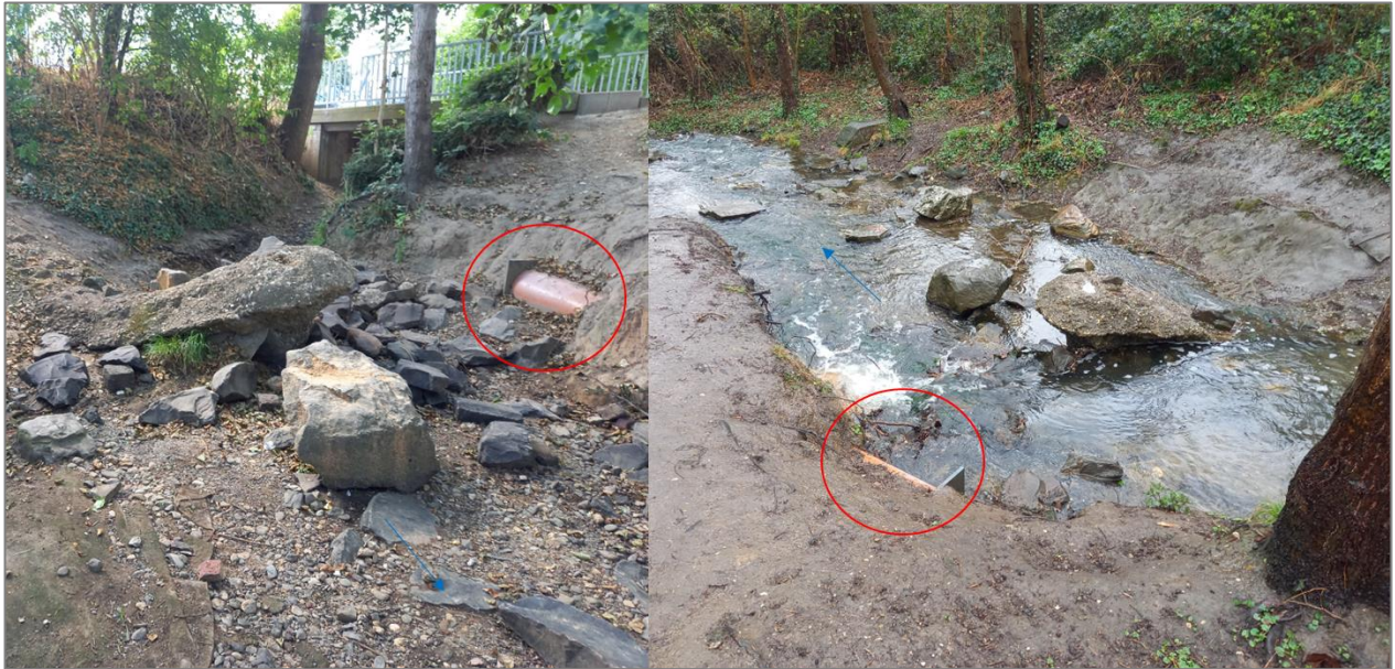
Abb. 2-13: Unbekannte Leitung am linken Ufer des Palmersdorfer Baches unterhalb der Brücke Brigidastraße
