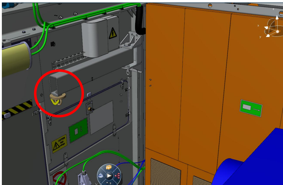
Abbildung 9: Beispielhafter Verankerungspunkt für die Notabseilvorrichtung in der Gondel
