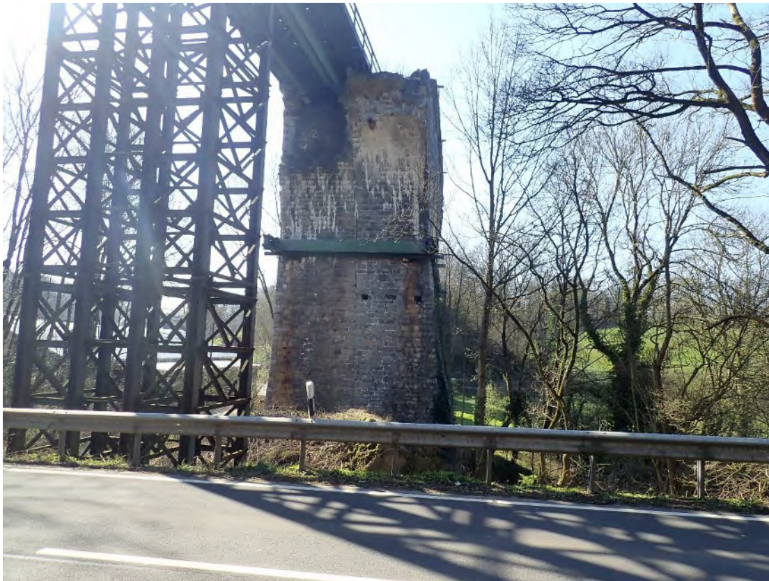
Abb. 4: provisorische Wiederherstellung des zerstörten Teiles des Viaduktes
