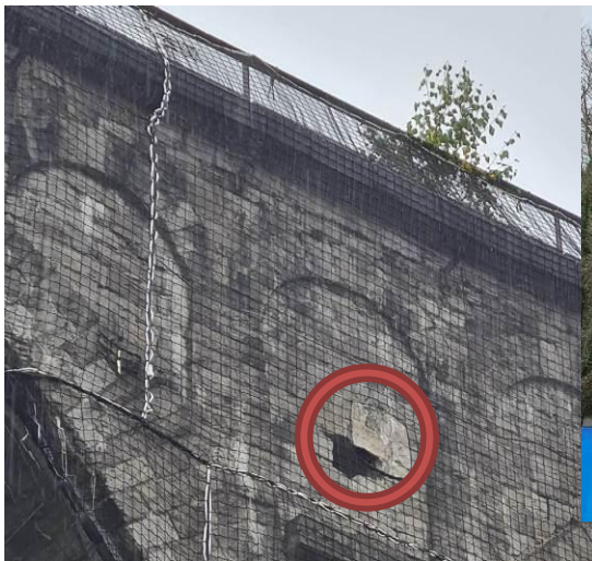
Abbildung 9: Detail Schutznetz. Die Markierung zeigt die Öffnung im Netz.
