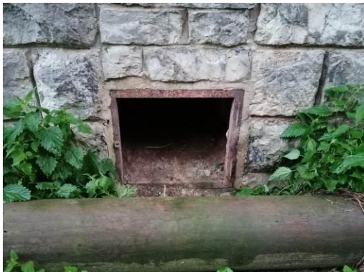
Abbildung 3: offene Klappe am Pfeiler 3.
