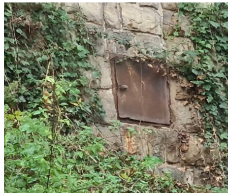
Abbildung 4: Verschlossene Öffnung am Pfeiler 1.
