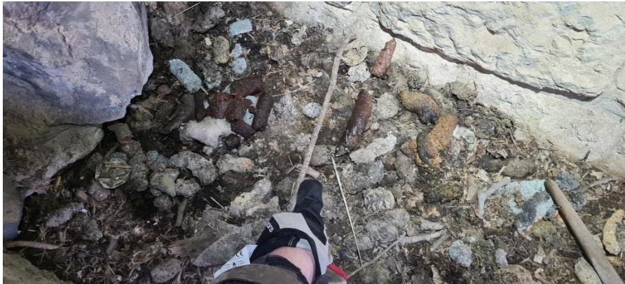
Abbildung 12: Kotspuren des Waschbärs in der Brückenkammer.
