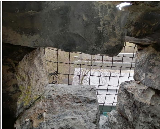
Abbildung 7: Mit Schutznetz verschlossenen große Öffnung in Pfeiler 4.
