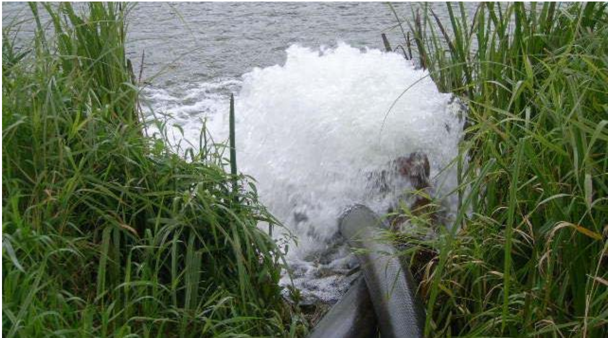
Abbildung 4: Beispiel einer direkten Einleitung des Grundwassers in Oberflächengewässer
