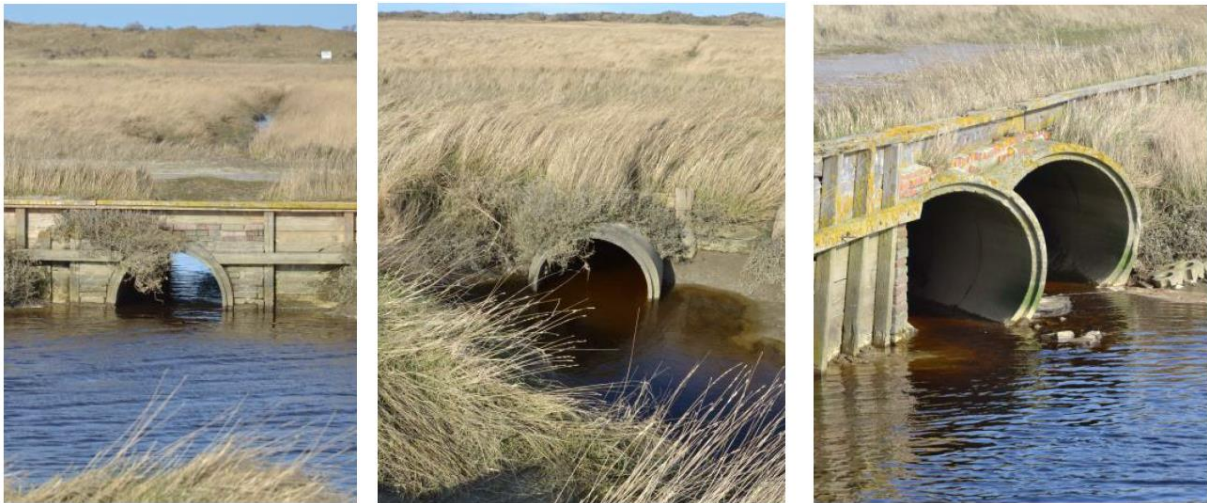
Abbildung 6-3: Rohrdurchlässe im „Katastrophenweg“
