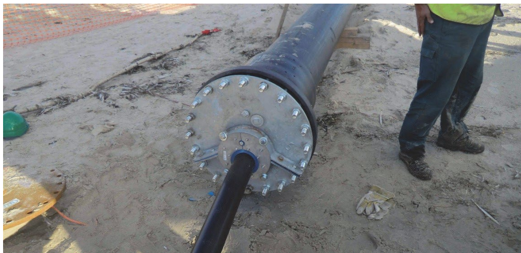
Abbildung 16: Kabel mit Abdichtung im Schutzrohr (Quelle: eos projekt).
