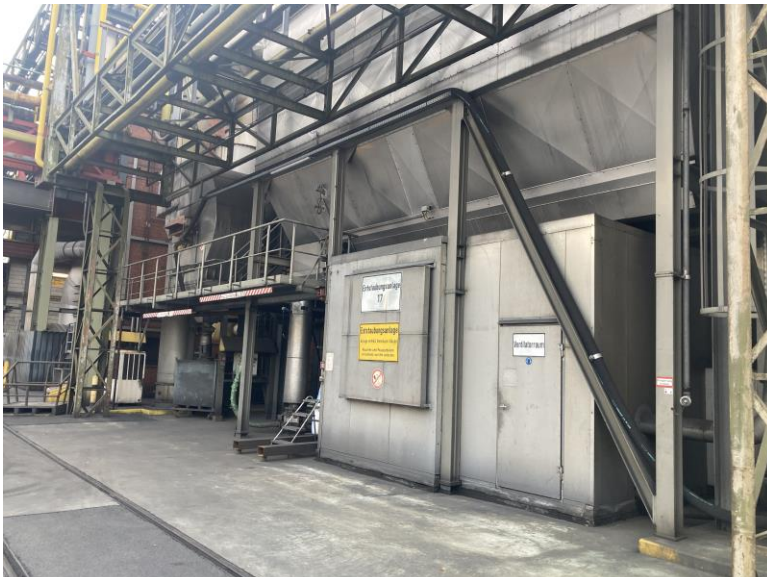
Abbildung 7: Entstaubung bei Silo 3.
