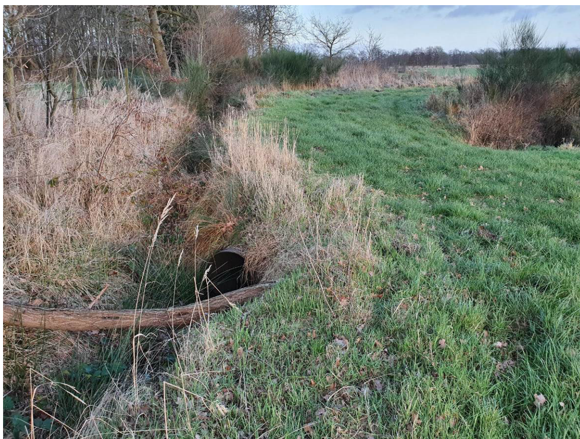
Foto 4: Rohrdurchlass zwischen dem Graben nördlich der Abbaustätte und dem zu ersetzenden Graben im Süden
