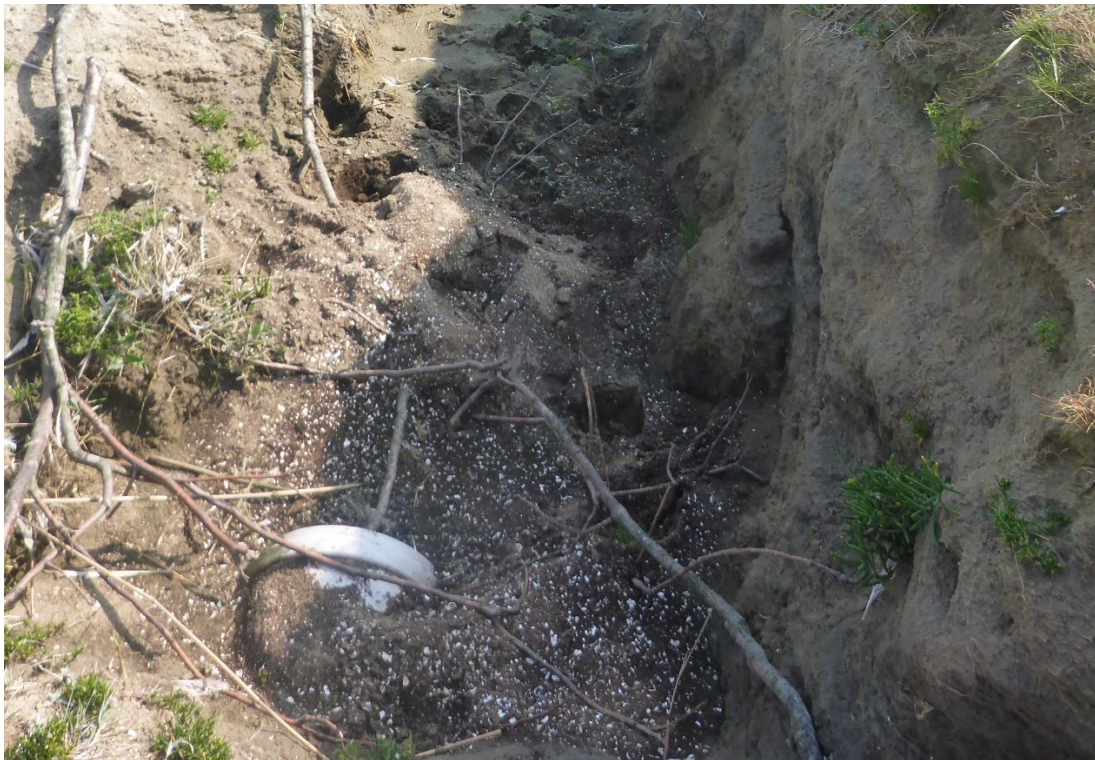
Abbildung 12: Entwässerungsrohr mit verlandetem Einlaufbereich (2020)
