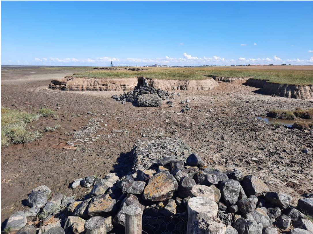
Abbildung 9: Südlichste Entwässerungsrinne, Sicherungselemente im Auslaufbereich (2022)
