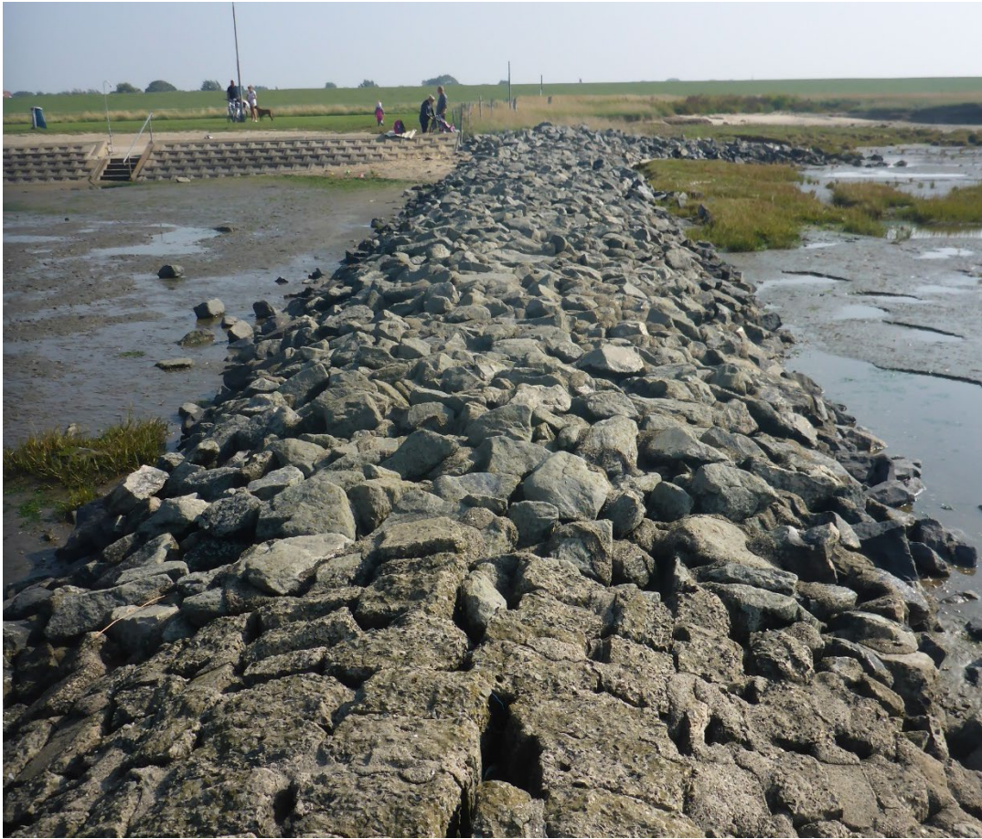
Abbildung 25: nördlich angrenzende Buhne, Blick in Richtung Vorland, rechts ungeschützt, links mit Deckwerk (2020)
