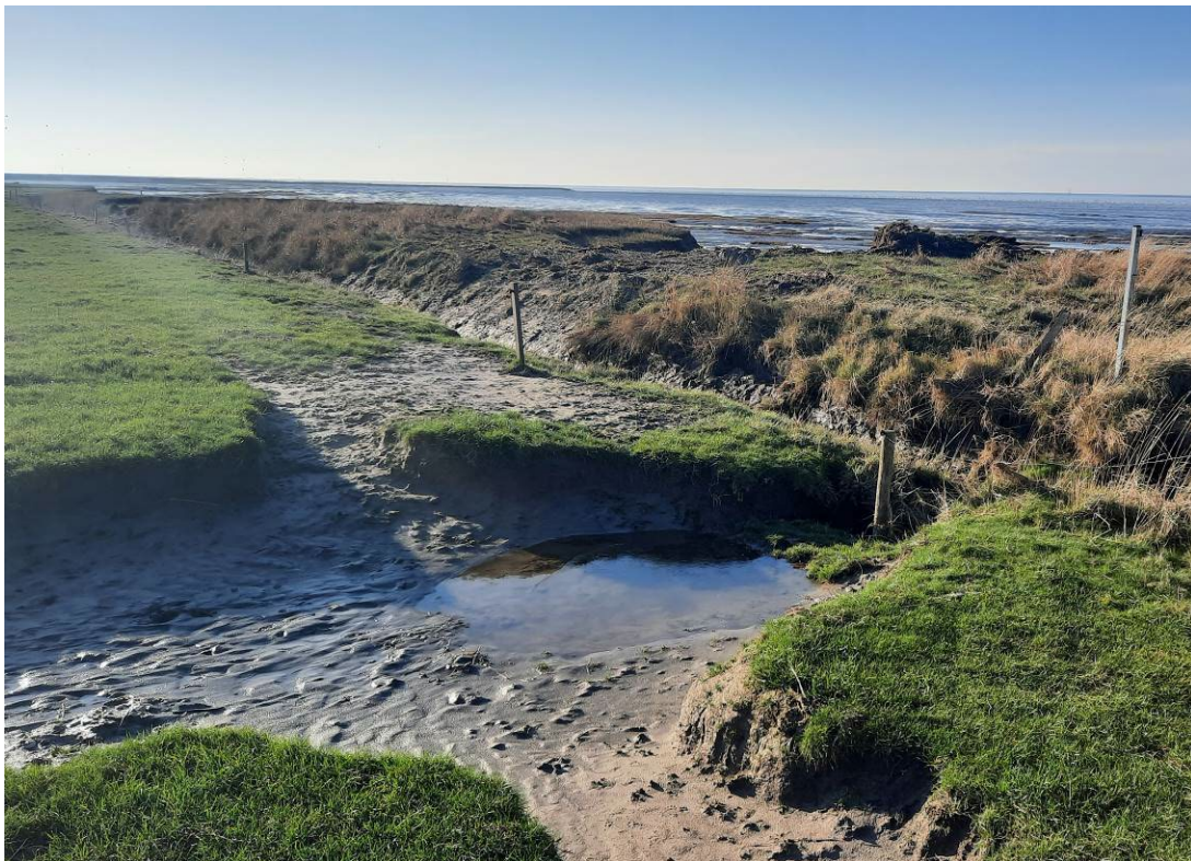
Abbildung 22: Verlandeter Anschluss Entwässerungsgraben an Entwässerungsrinne aus nördlichem Vorland (2022)
