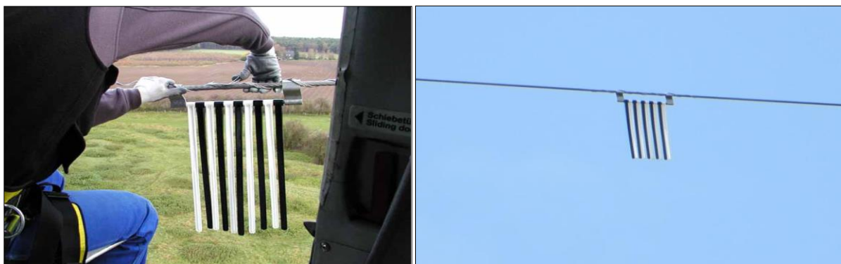
Abbildung 3: Vogelschutzmarker am Erdseil. Dem Stand der Technik entsprechen bewegliche, schwarz-weiße Lamellenmarker.
